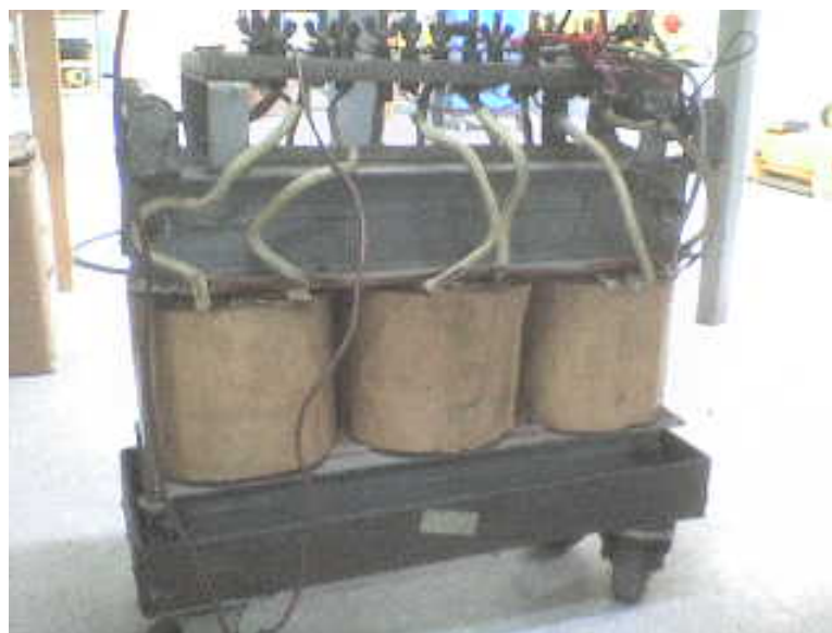
Figura D.7: Transformador trifásico de 8 kVA utilizado
