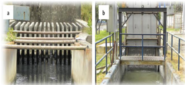
Figura 4. Rejillas y desarenador para la etapa de tratamiento preliminar.
