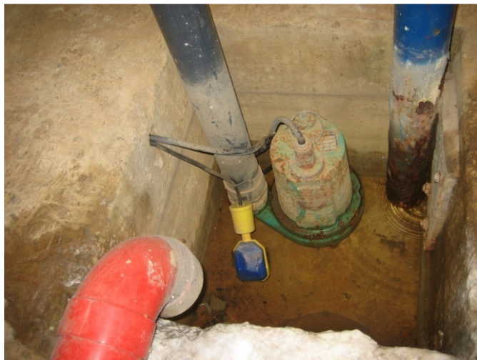
Foto 4 – Bomba de limpieza
