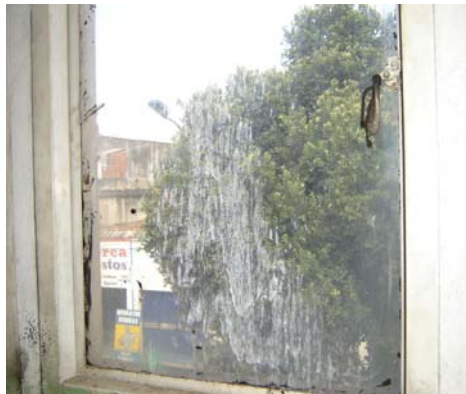
Figura 20. Ventana sucia y manchada
