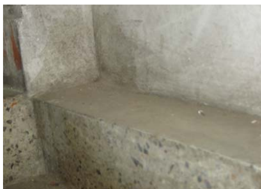
Figura 19. Escaleras llenas de polvo y desperdicios
