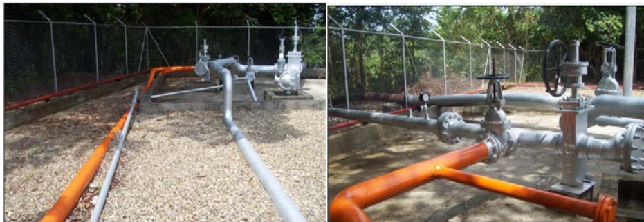
Figura 14. Salida de la Línea de Transferencia de Emulsión desde la GS-1 Rumbo a la Estación Principal.
