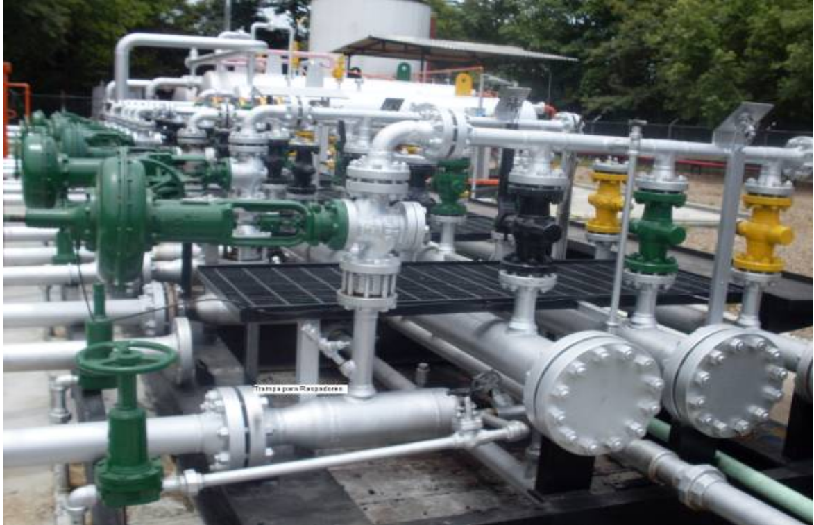
Figura 9. Detalle distribución del Manifold
