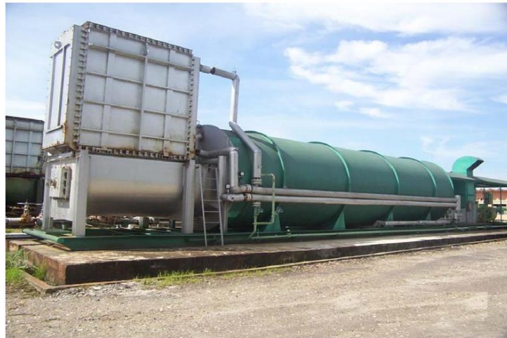
Figura 6. Generador de Vapor.
