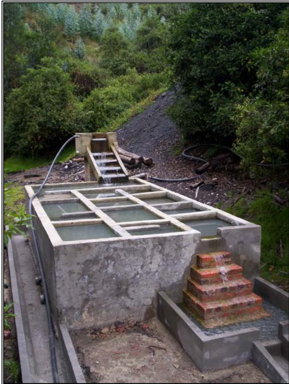
Figura 4. Pila de Sedimentación, Mina el Convenio, zona del Triunfo. Se busca oxidar el agua para que precipiten óxidos y sulfatos, por medio de los filtros eliminarlos del agua para verterlas a las quebradas cercanas.
