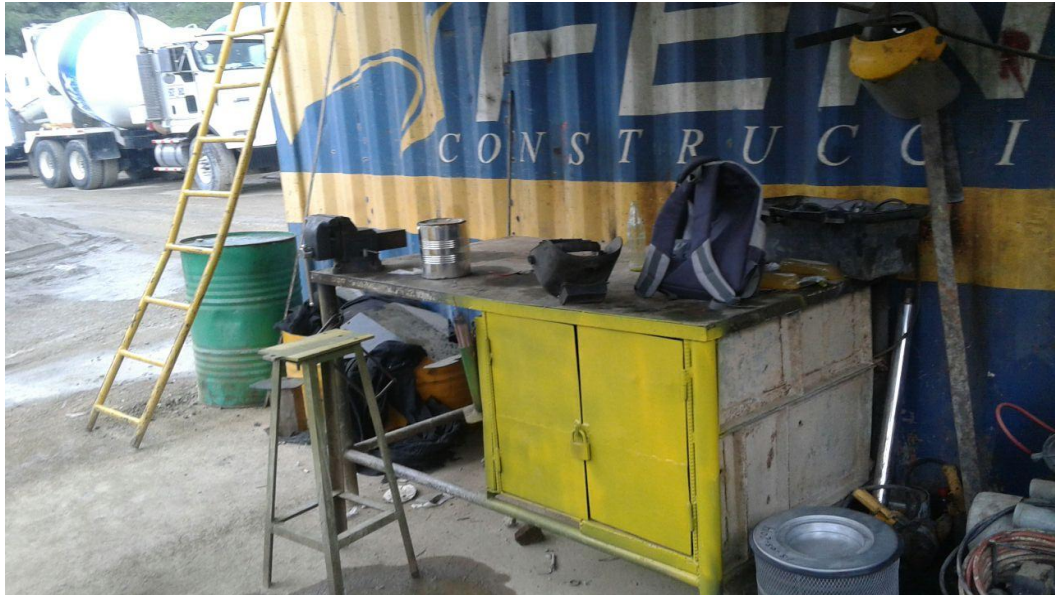
Figura 11. Zona destinada para las actividades de mantenimiento de equipos menores
