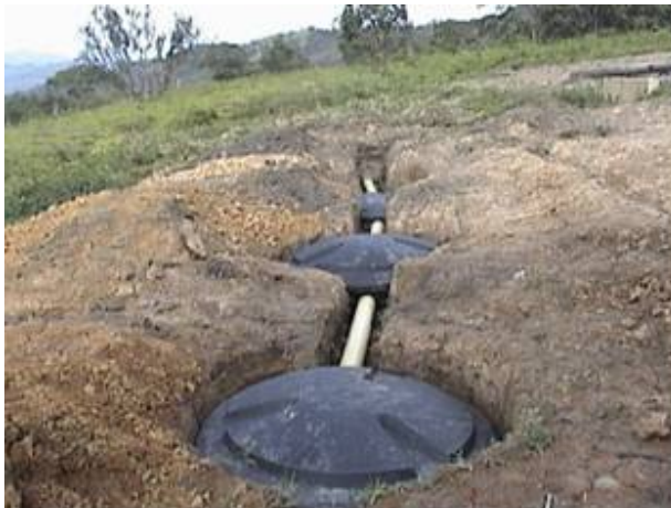
Figura 16. Pozo séptico para tratamiento aguas de lavado
