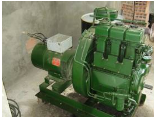
Figura 53. Planta generadora de energía
