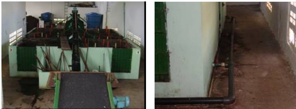
Figura 117. Tubos PVC para aireación
