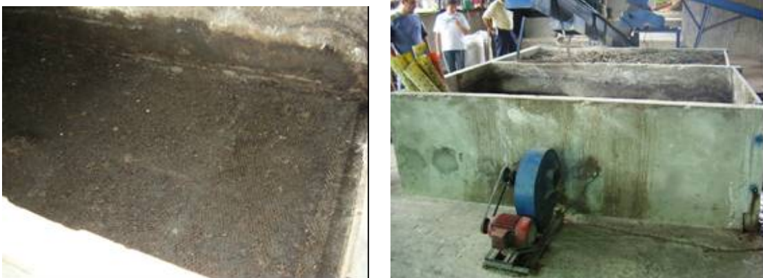
Figura 49. Malla fondo de la celda y ventilador de aireación celdas
