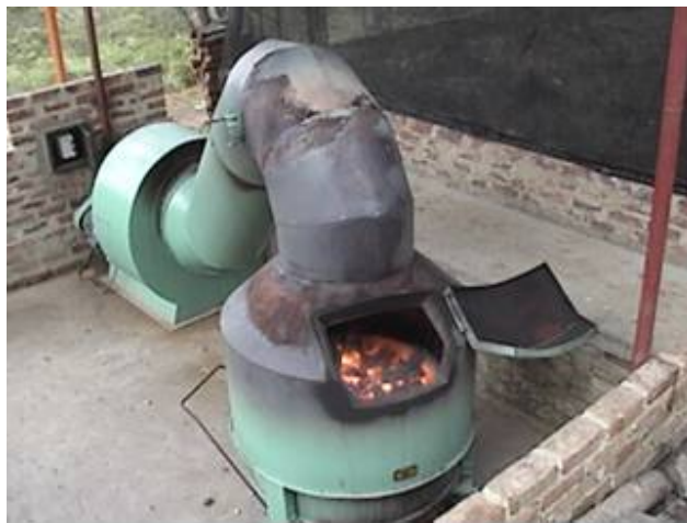
Figura 11. Ventilador y Generador de aire caliente
