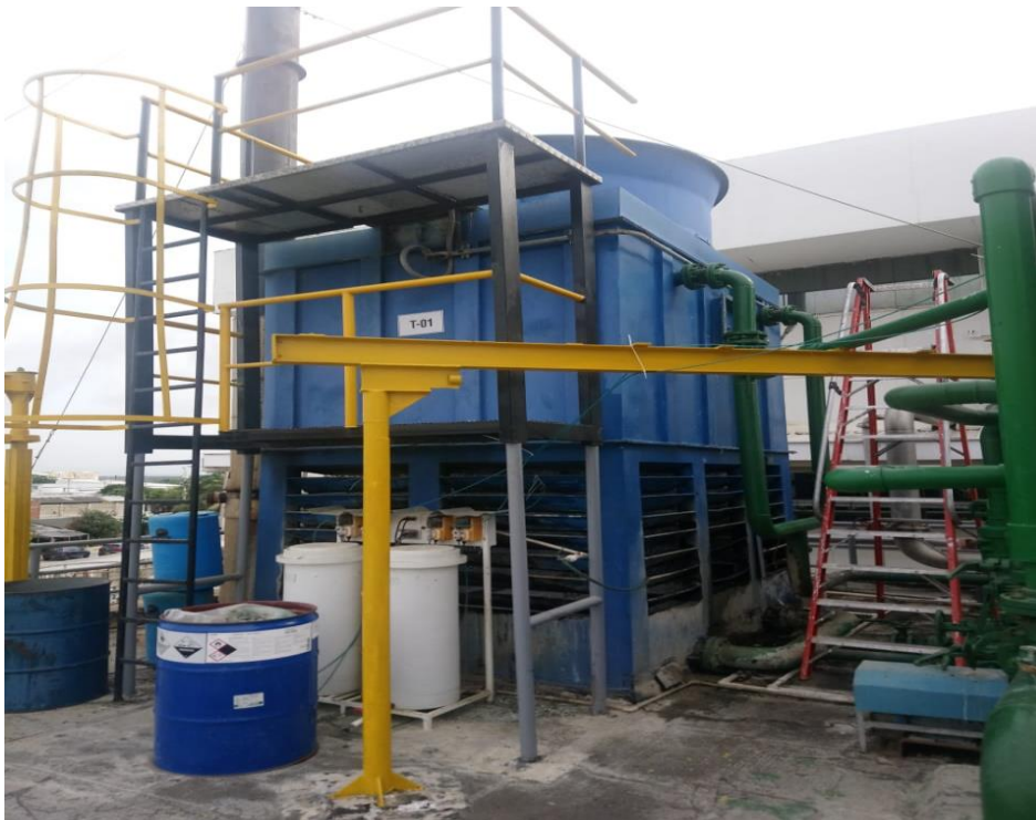
Figura 4. Torre de enfriamiento PP800M
