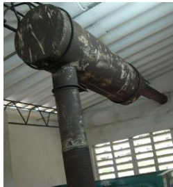
Figura 18. Tubería de escape y silenciador
