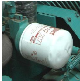
Figura 10. Filtro de agua refrigerante.
