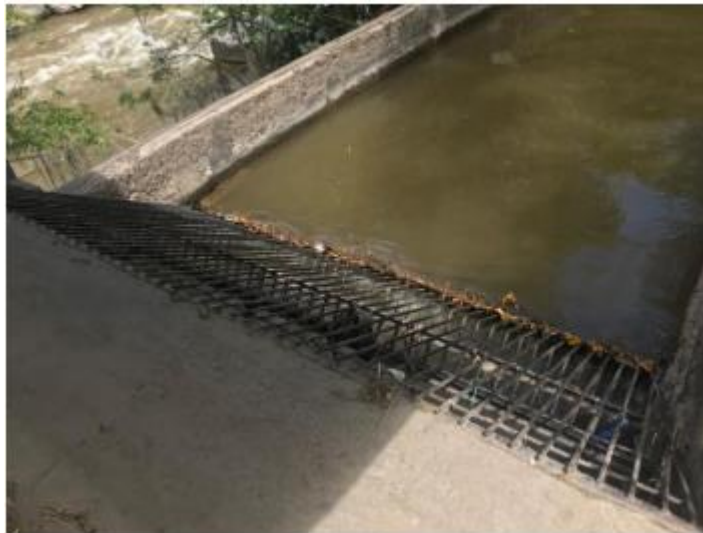
Figura 10. Obstrucción mínima en la rejilla del canal de la PCH La Cascada
