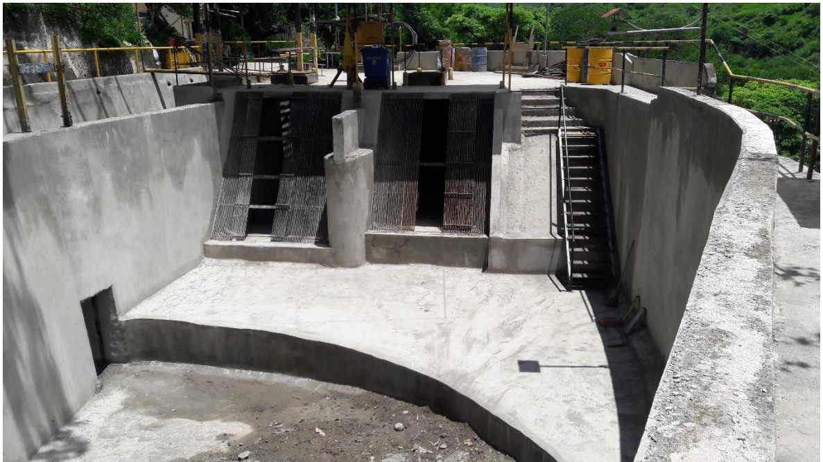
Figura 5. Desarenador PCH La Cascada
