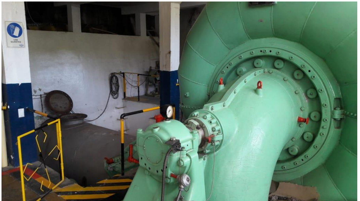
Figura 7. Turbina tipo Francis, central hidroeléctrica La Cascada
