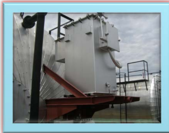
Figura 29. Fotografía de Transformador
