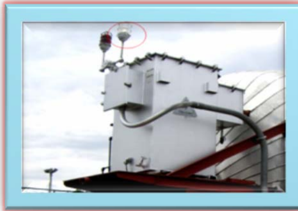
Figura 30. Fotografía Luz indicadora del Transformador
