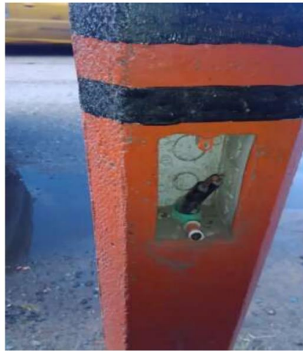
Foto 4 Estación de prueba Ferrocarril.
