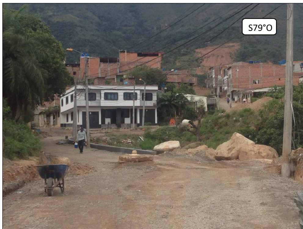
Figura 35. Obras en ejecución para la estabilización de la vía localizada sobre el talud del EG D7.
