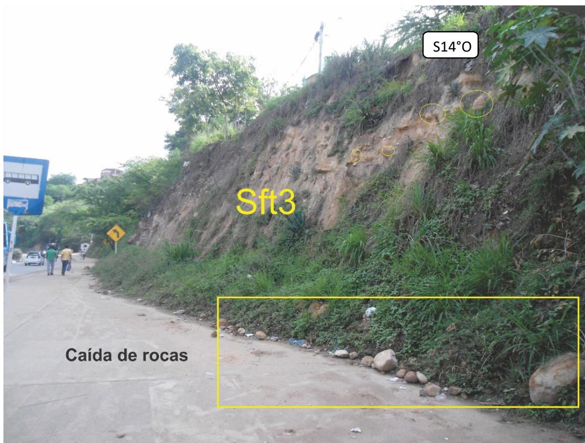
Figura 49. Caída de detritos en la entrada al barrio Mirador de San Juan.
