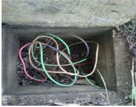
Caja de Inspección CI 21
