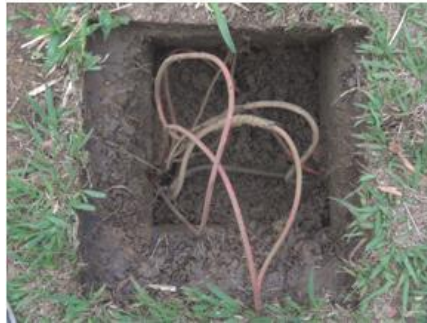
Caja de Inspección CI_F4
