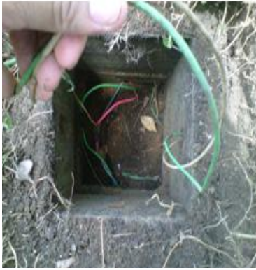
Caja de Inspección CI 19
