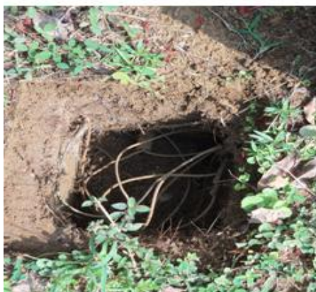
Caja de Inspección CI1
