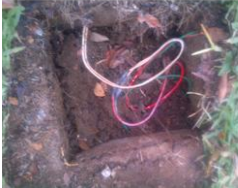
Caja de Inspección CI3
