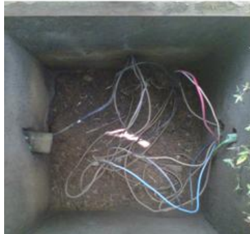
Caja de Inspección CI 8
