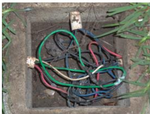
Caja de Inspección CI_T6
