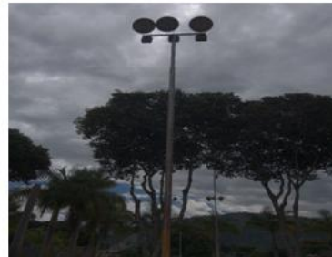
Poste metálico PB2
