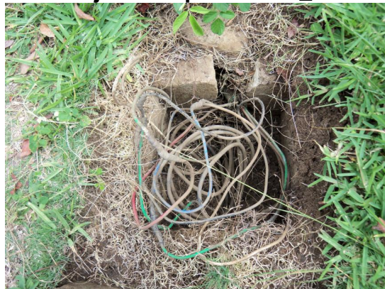
Caja de Inspección CI_2
