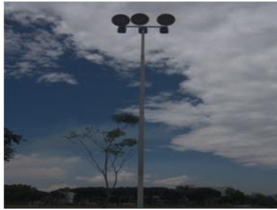
Poste metálico PB4
