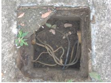
Caja de Inspección CI_B1
