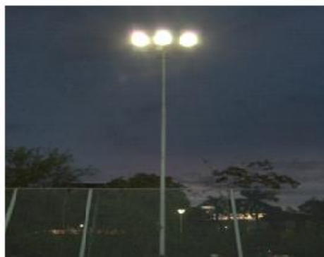
Poste metálico PT5
