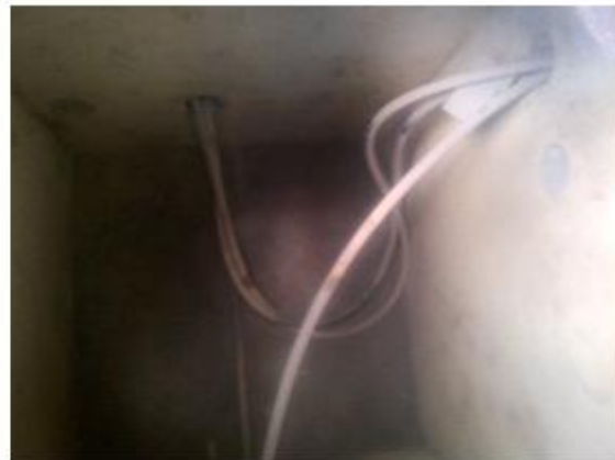
Caja de Inspección CIP2
