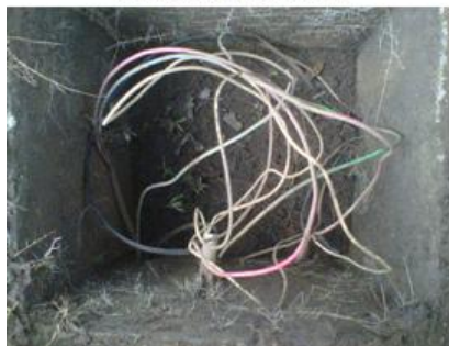
Caja de Inspección CI 16
