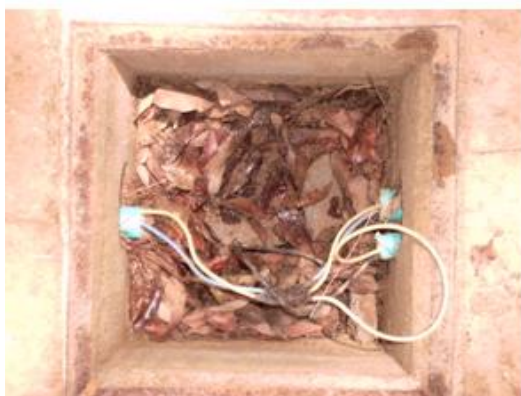
Caja de Inspección CI5
