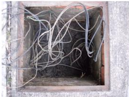
Caja de Inspección CI 24
