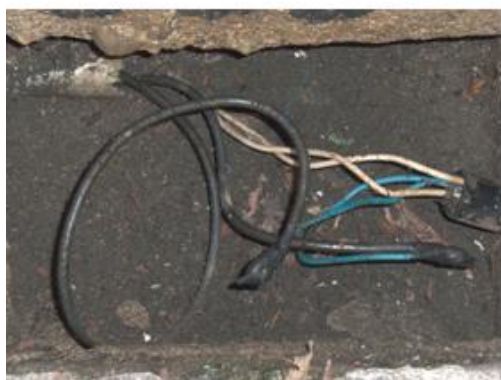
Caja de Inspección CI_T4
