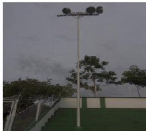
Poste metálico PT1
