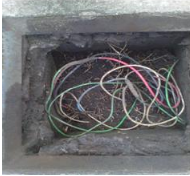
Caja de Inspección CI 7
