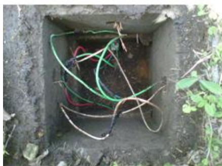
Caja de Inspección CI 18
