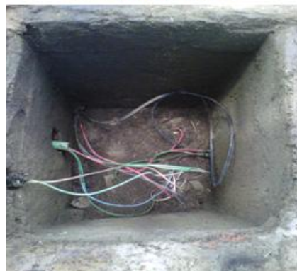
Caja de Inspección CI 17
