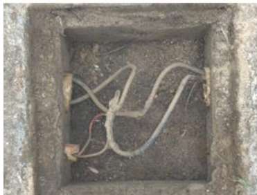
Caja de Inspección CI_B2
