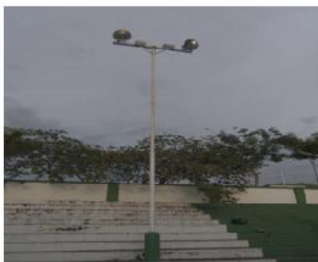
Poste metálico PT3
