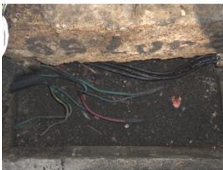
Caja de Inspección CI_T2
