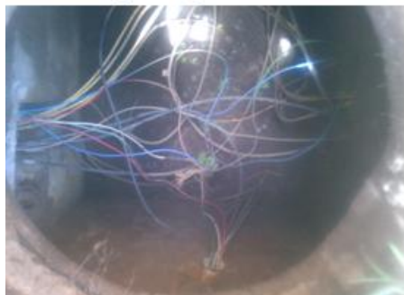
Caja de Inspección CI B.T
