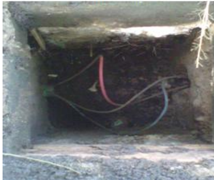
Caja de Inspección CI 27
