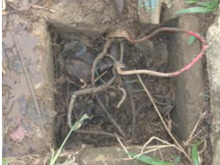
Caja de Inspección CI_F3
