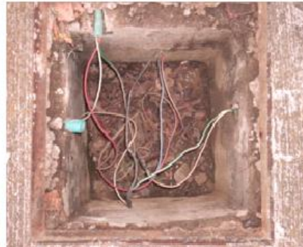
Caja de Inspección CI 28
