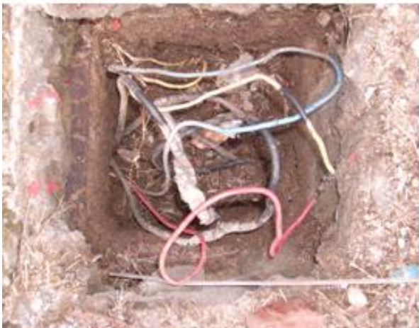
Caja de Inspección CI_C5
