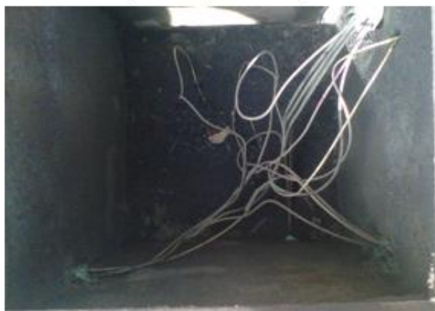
Caja de Inspección CI_GP
