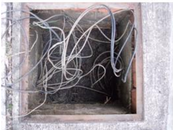
Caja de Inspección CI 24
