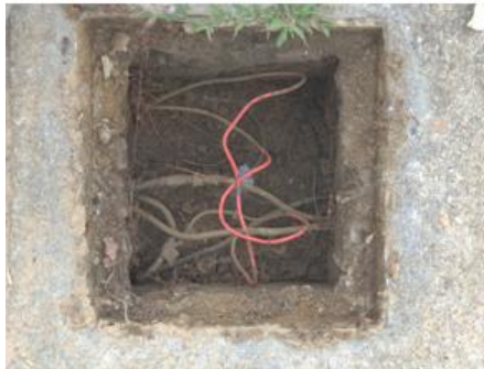
Caja de Inspección CI_F5
