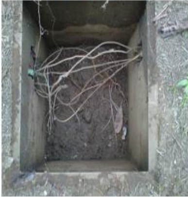
Caja de Inspección CI 11
