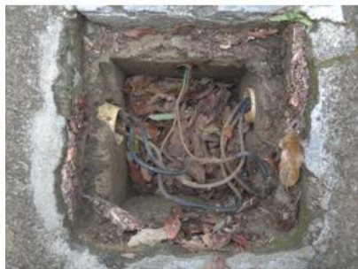
Caja de Inspección CI_F1
