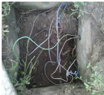
Caja de Inspección CI 9
