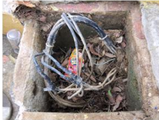
Caja de Inspección CI_C2
