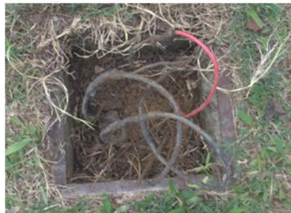
Caja de Inspección CI_B3
