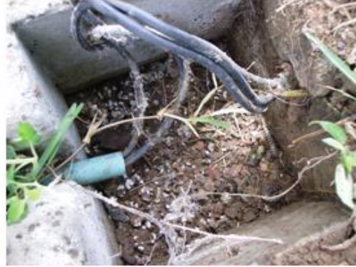
Caja de Inspección CI_C7
