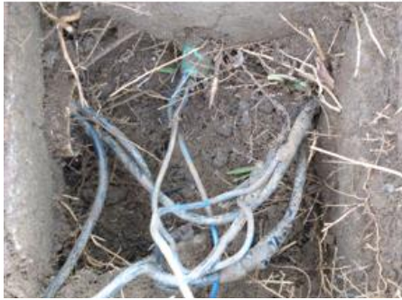
Caja de Inspección CI_F7
