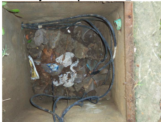
Caja de Inspección CI_C
