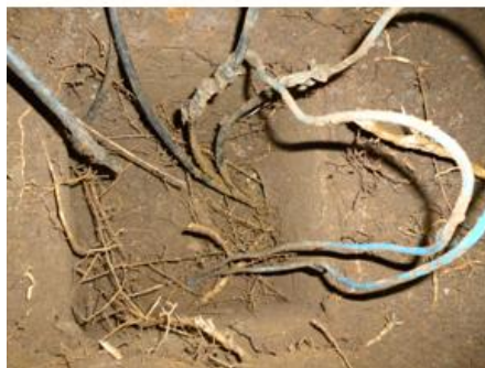
Caja de Inspección CI_F9
