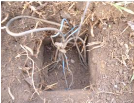
Caja de Inspección CI_F8
