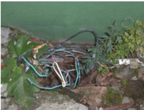
Caja de Inspección CI_T1
