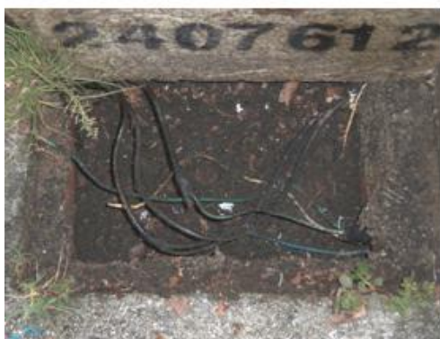
Caja de Inspección CI_T3
