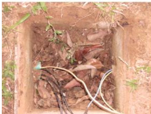
Caja de Inspección CI4
