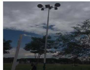
Poste metálico PV1, PV2
