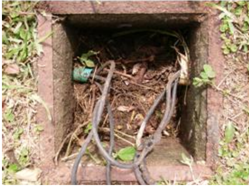
Caja de Inspección CI_C6
