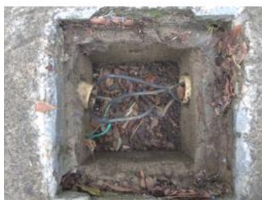
Caja de Inspección CI_F2
