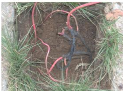
Caja de Inspección CI_F6
