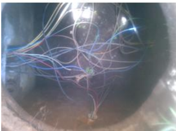
Caja de Inspección CI B.T
