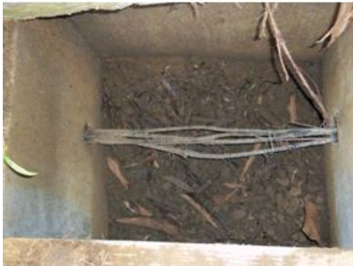
Caja de Inspección CI_C1
