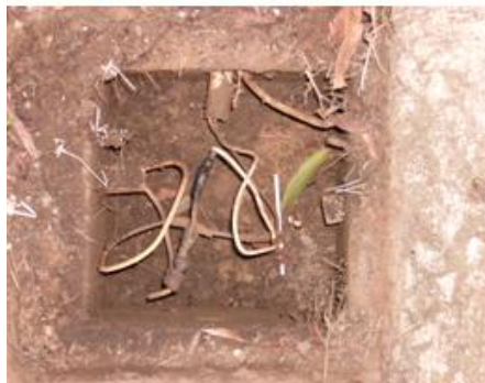
Caja de Inspección CIF
