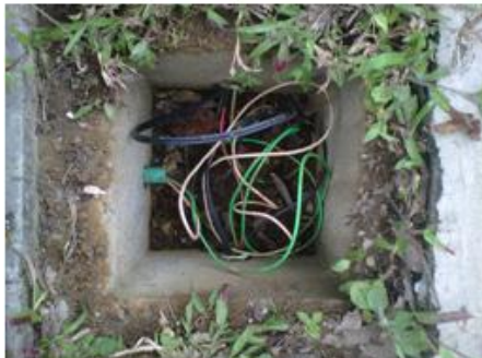
Caja de Inspección CI 22
