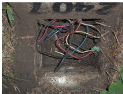
Caja de Inspección CI_T7
