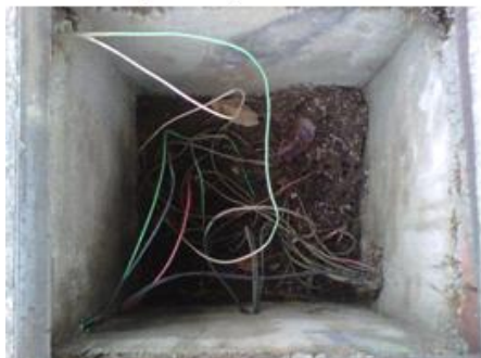
Caja de Inspección CI 23
