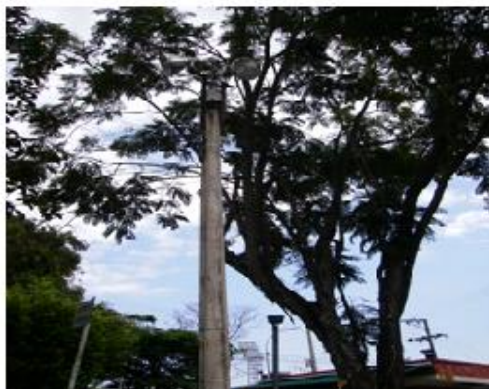
Poste de concreto 8 m PC 23, Retención
