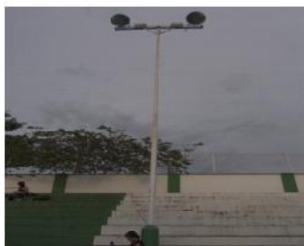
Poste metálico PT2
