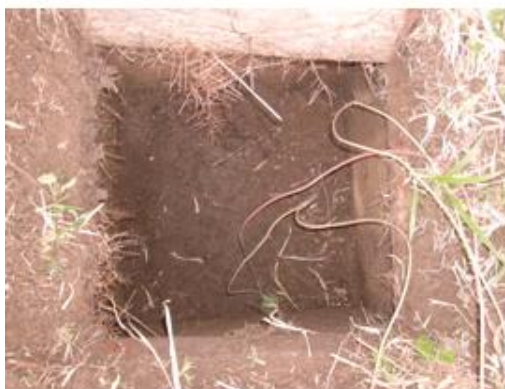
Caja de Inspección CI 25
