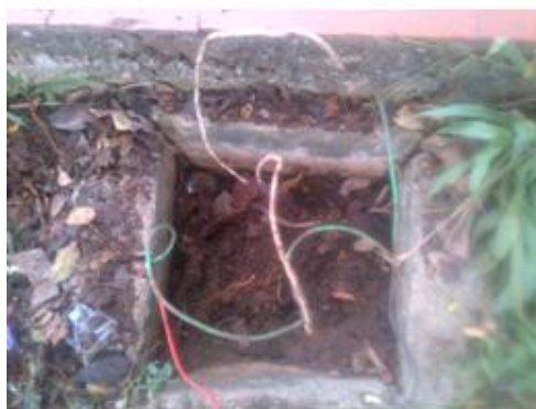
Caja de Inspección CI2
