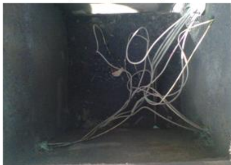
Caja de Inspección CI_GP
