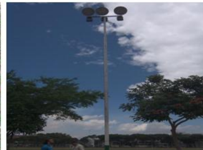
Poste metálico PB3
