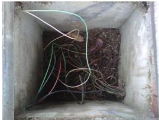
Caja de Inspección CI 23
