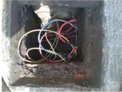
Caja de Inspección CI 26
