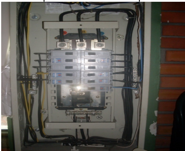
Figura 32. Interruptores sin numeración para identificación.
