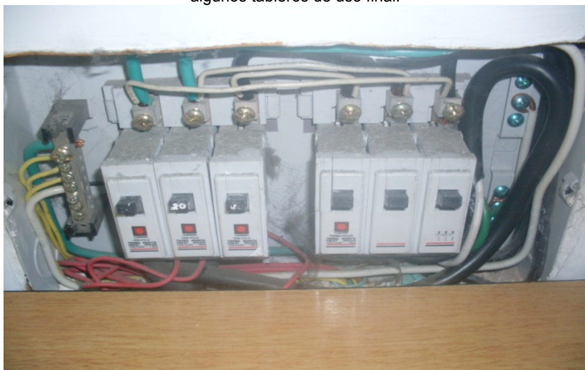
Figura 34. Imagen que muestran la acumulación de suciedad presentes en algunos tableros de uso final.
