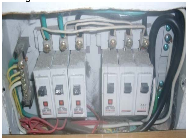
Figura 20. Tablero de uso final TC2B
