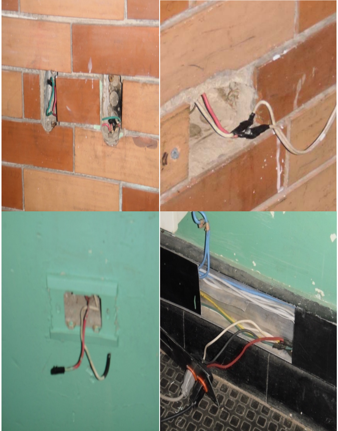
Figura 35. Algunos casos de cableado peligrosamente expuesto
