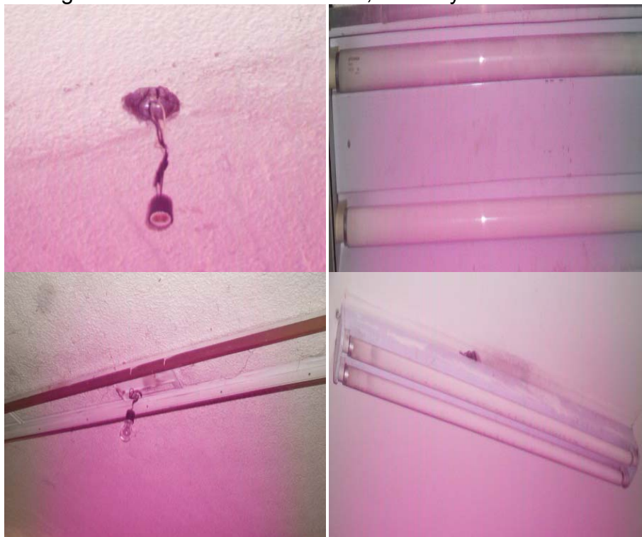
Figura 49. Luminarias averiadas, sucias y en mal estado
