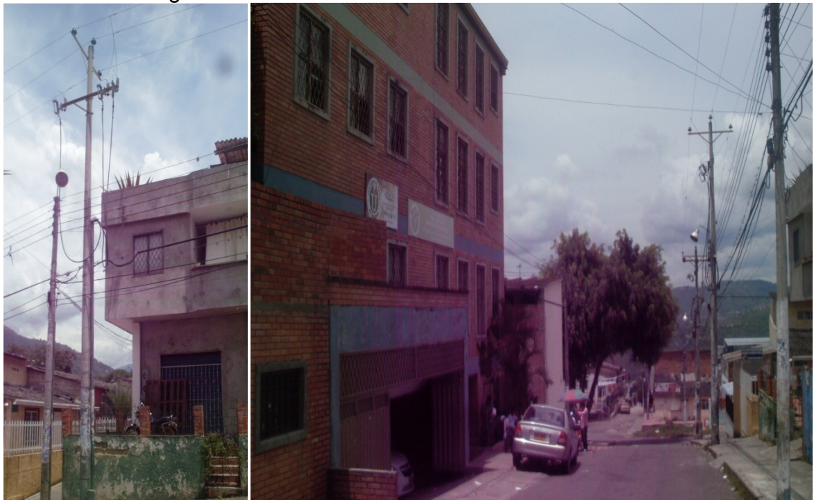
Figura 6. Ubicación de acometida de media tensión.
