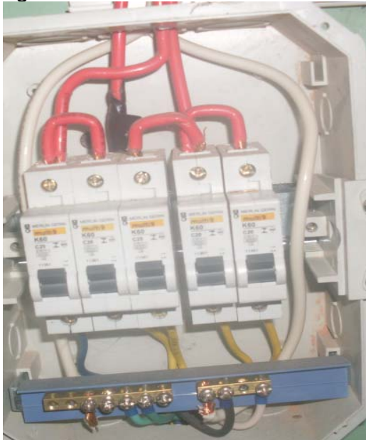
Figura 28. Tablero de uso final TC3H
