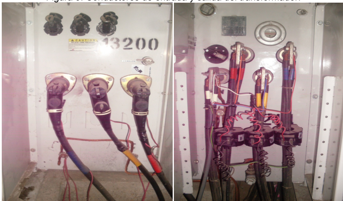
Figura 9. Conductores de entrada y salida del transformador.
