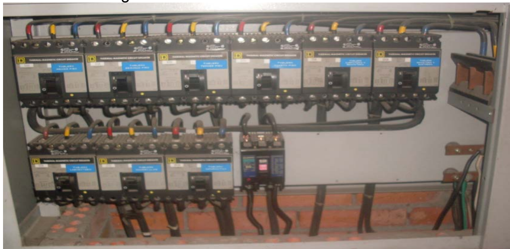
Figura 14. Totalizadores Tablero General
