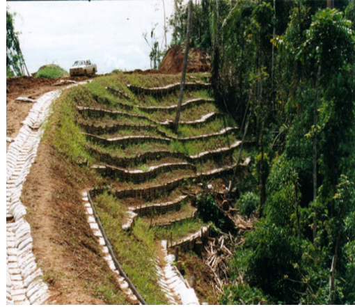
Fig. 4 Drenes para estabilización de taludes.
