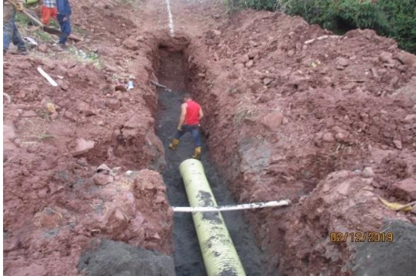
Figura 25 Red de desagüe del tanque de almacenamiento
