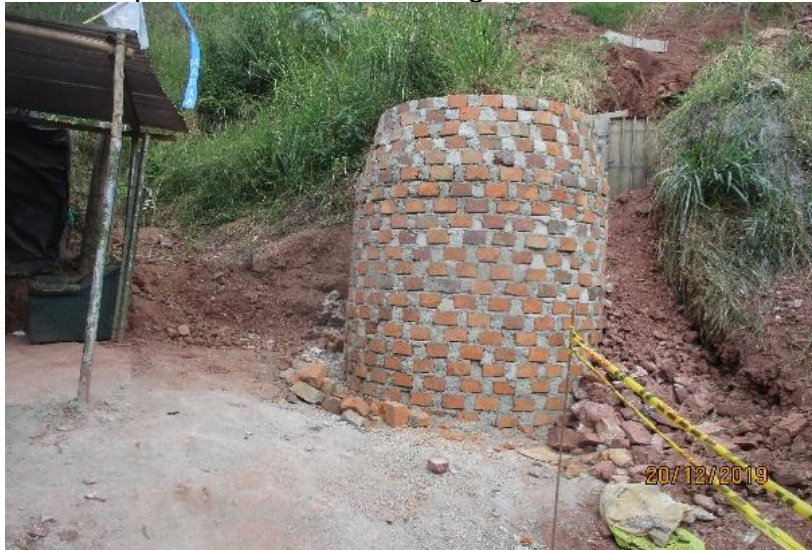
Figura 26 Pozo de inspección de red de desagüe
