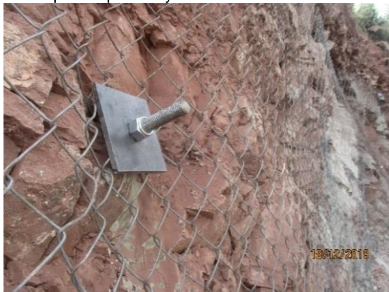
Figura 22 Detalle de pernos pasivos y malla doble torsión
