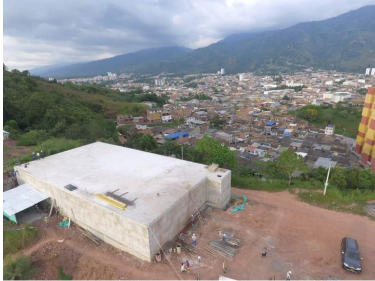
Figura 19 Tanque de almacenamiento vista exterior
