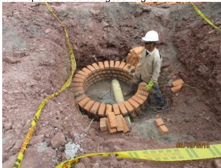
Figura 32 Pozos de inspección red de aguas negras
