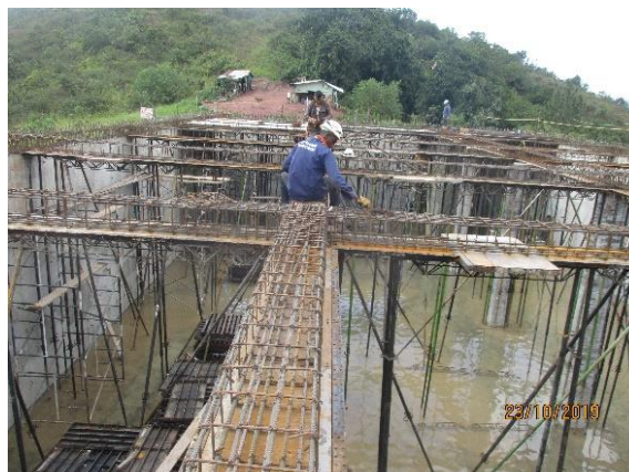
Figura 15 Colocación del encofrado y acero de la cubierta del tanque de almacenamiento
