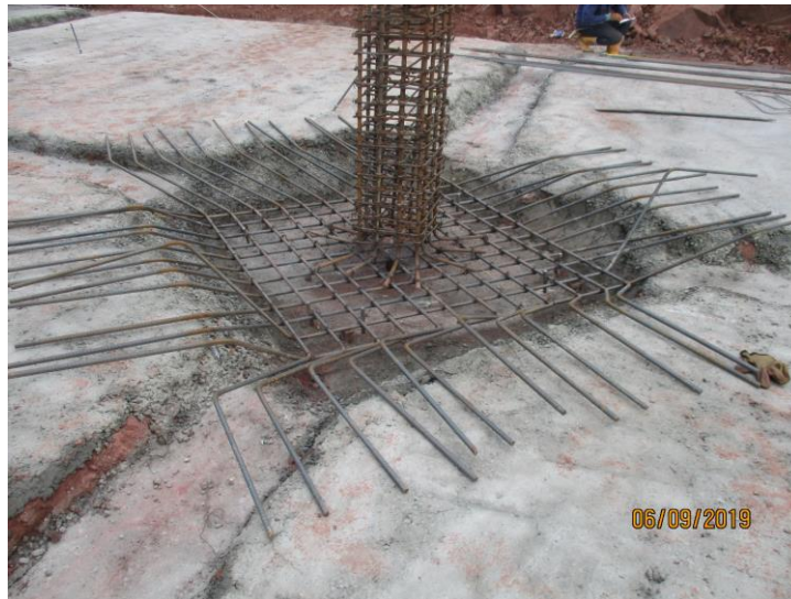
Figura 6 Colocación de acero de la zapatas y columnas del tanque de almacenamiento
