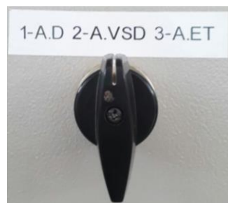
Figura 74: SEL_4 en la posición de arranque por variador de velocidad.
