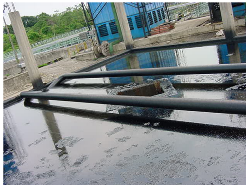
Foto 8. Imagen de lecho de Secado colmatado
