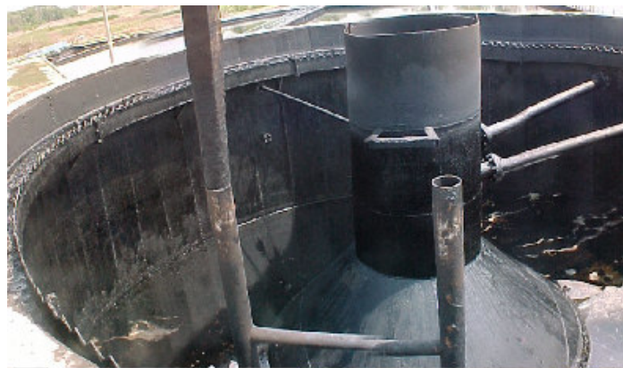
Foto 27. Vista interior del canal perimetral de agua y la campana decantadora, en uno de los tanques espesadores de la Refinería de Cartagena
