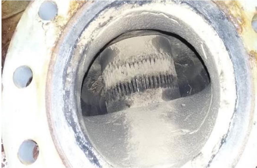
Fuente: Propia. (Fotografía área calderas)
