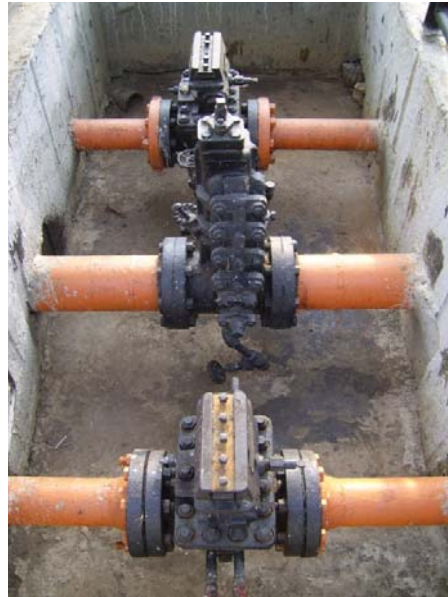
Figura 31. Medidor de gas Daniels
