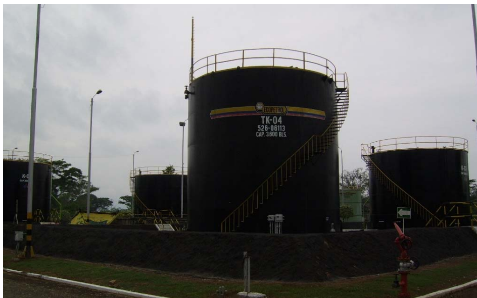
Figura 28. Tanques de almacenamiento de la Estación Auxiliar
