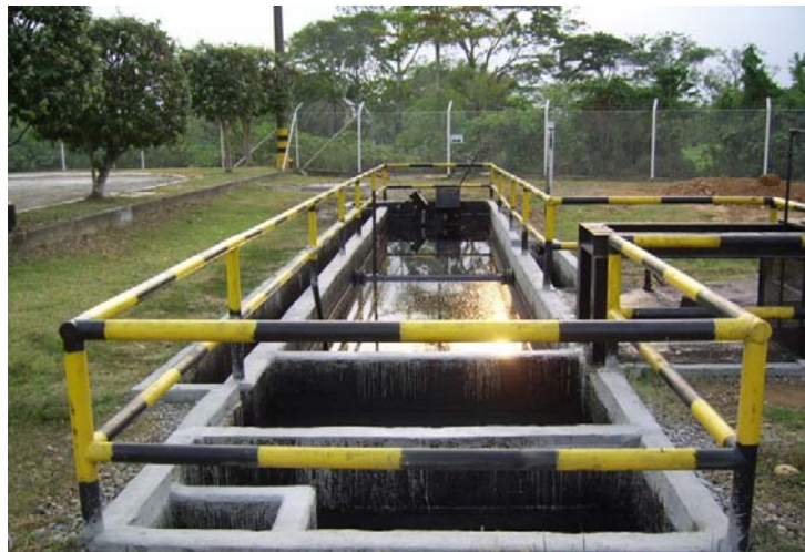
Figura 30. Separador API de la Estación Auxiliar.
