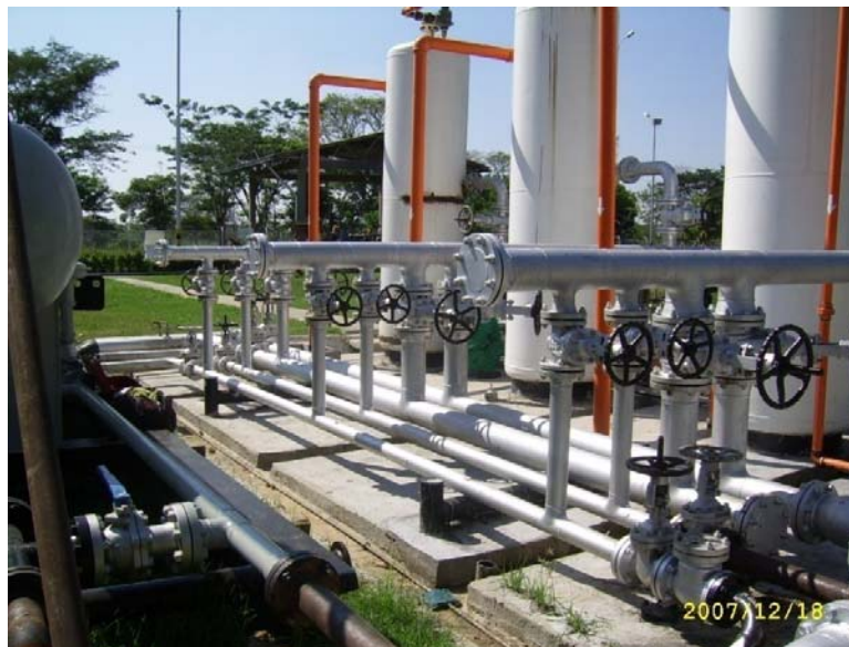
Figura 24. Múltiples de prueba y varios en la entrada a los separadores
