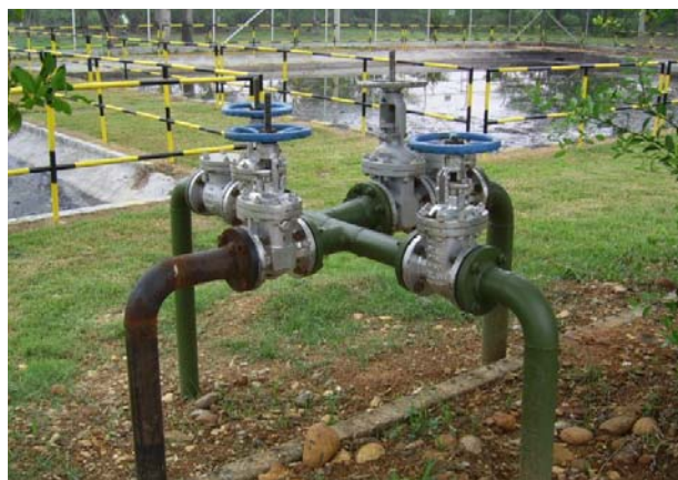
Figura 32. Válvulas tipo compuerta.
