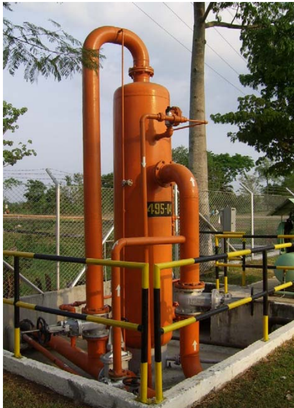
Figura 27. Scrubber de la Estación Auxiliar
