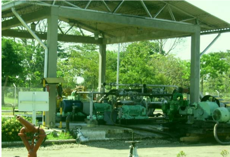
Figura 29. Área de bombeo de la Estación Auxiliar.
