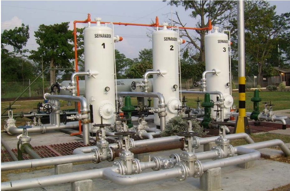
Figura 26. Separadores de prueba y varios de la Estación Auxiliar.
