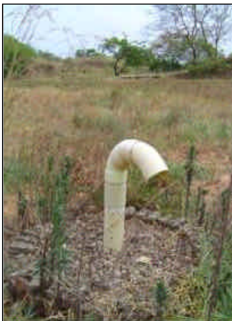
FOTO 16. CHIMENEA PARA GASES
