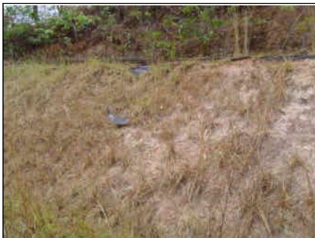
FOTO 6. TALUD DESPROVISTO DE GEOMEMBRANA
