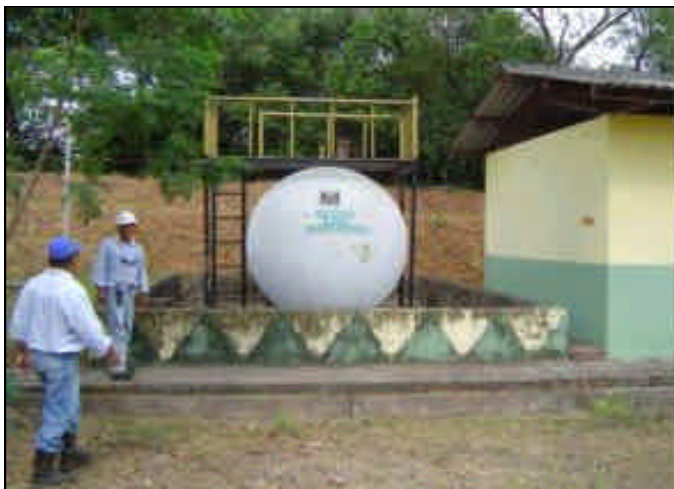
FOTO 40 ALMACENAMIENTO DE COMBUSTIBLE
