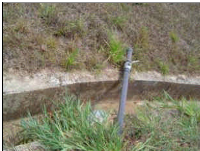
FOTO 9. SISTEMA DE RECIRCULACIÓN DE LIXIVIADOS
