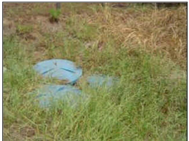
FOTO 47 SISTEMA DE TRATAMIENTO DE AGUAS RESIDUALES DOMESTICAS
