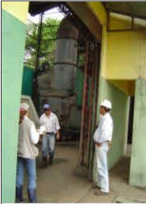
FOTO 38 ÁREA DE INCINERACIÓN
