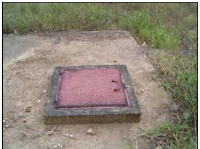
FOTO 33 TANQUE PARA SUMINISTRO DE AGUA
