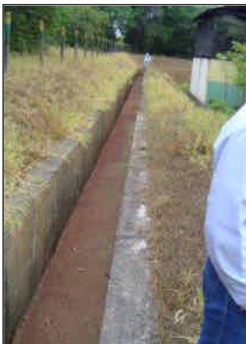
FOTO 36 CUNETETA PARA CONDUCCION DE AGUA LLUVIA
