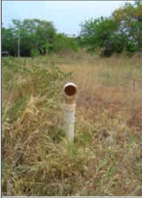
FOTO 18. CHIMENEA PARA GASES
