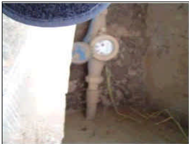
FOTO 34 REGULADOR PARA AGUA POTABLE
