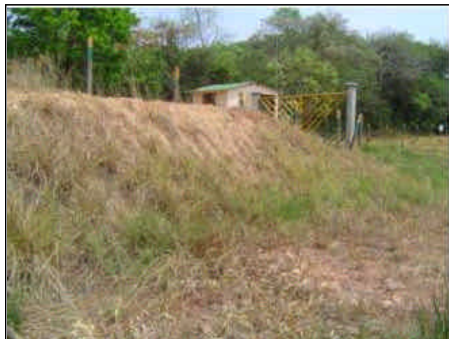
FOTO 7. TALUD DESPROVISTO DE GEOMEMBRANA
