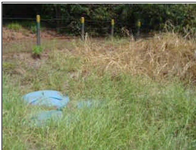
FOTO 46 SISTEMA DE TRATAMIENTO DE AGUAS RESIDUALES DOMESTICAS
