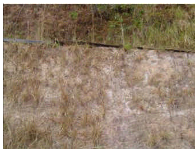
FOTO 5. TALUD DESPROVISTO DE GEOMEMBRANA
