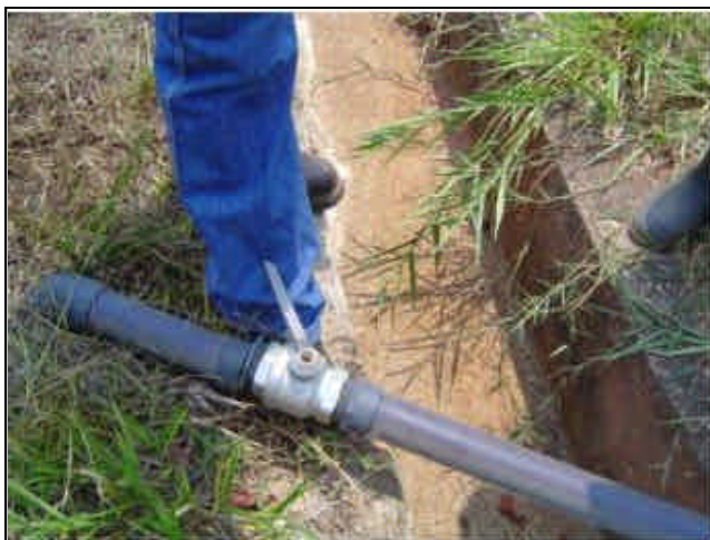
FOTO 8. SISTEMA DE RECIRCULACIÓN DE LIXIVIADOS
