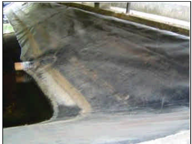
FOTO 13. PISCINA PARA LIXIVIADOS
