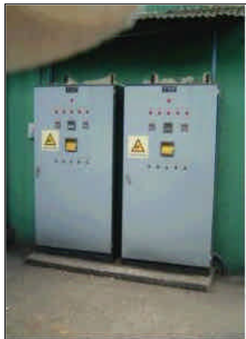
FOTO 41 CONTROLES ELÉCTRICOS DEL HORNO DE INCINERACIÓN
