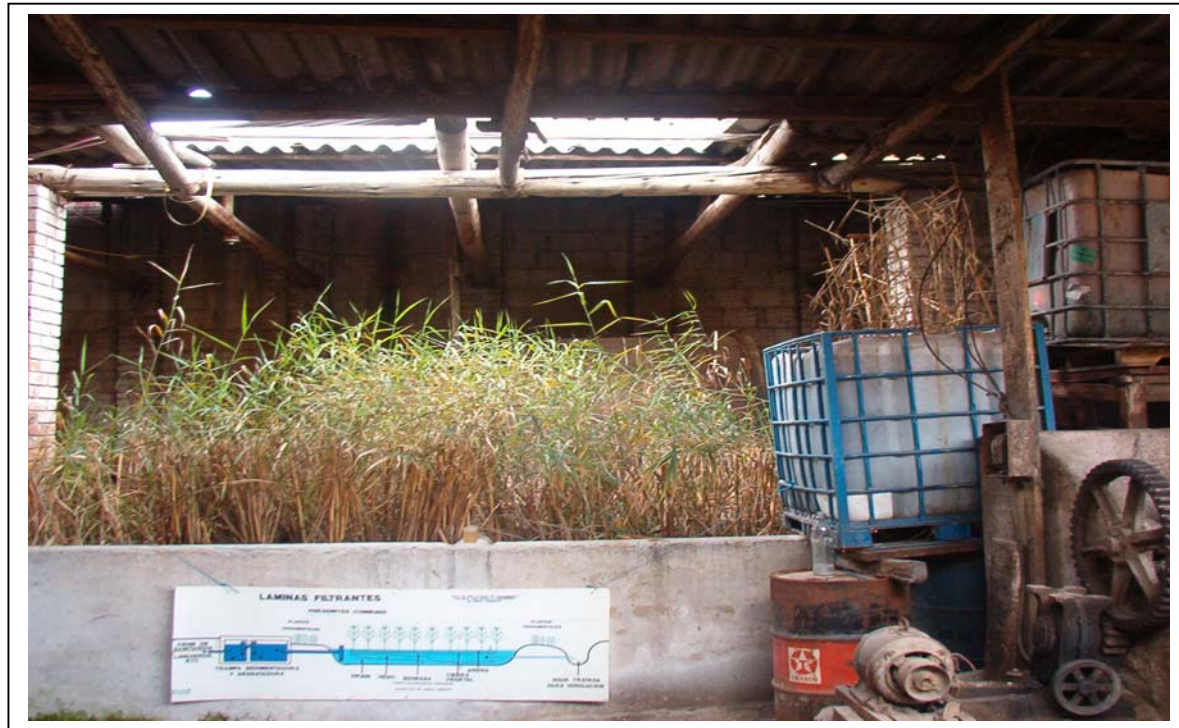
Figura 34. Planta de Tratamiento Vertical y Horizontal Utilizada para Aguas Residuales de Curtiembres
