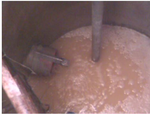
Figura 16. Llegada de Aguas al Pozo de la PTAR.
