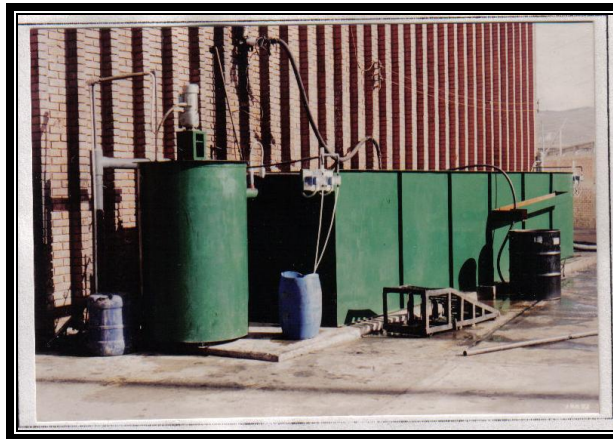
Figura 1. Vista general planta instalada en 1992
