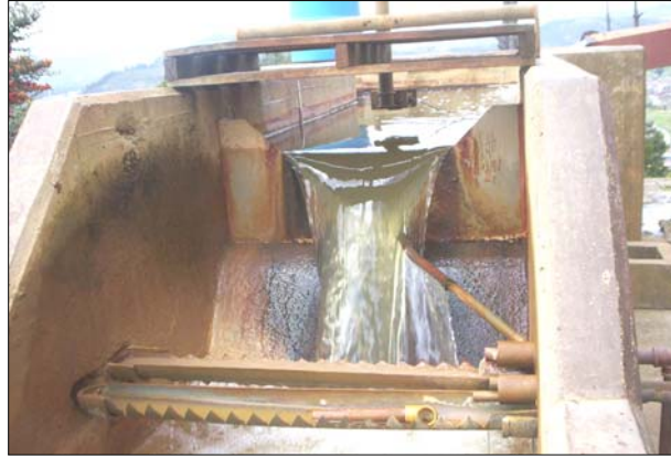
Figura 11. Vertedero y Dosificación
