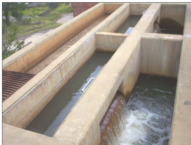
Figura 12. Filtros y Sedimentadores
