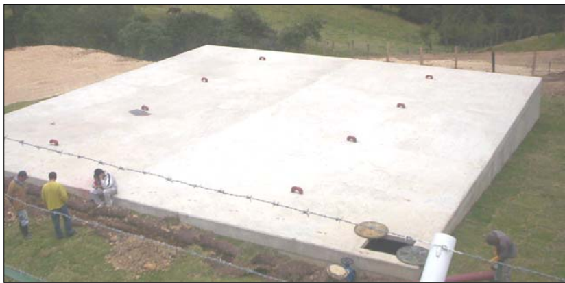
Figura 15. Tanque de Almacenamiento 1000m 3 .
