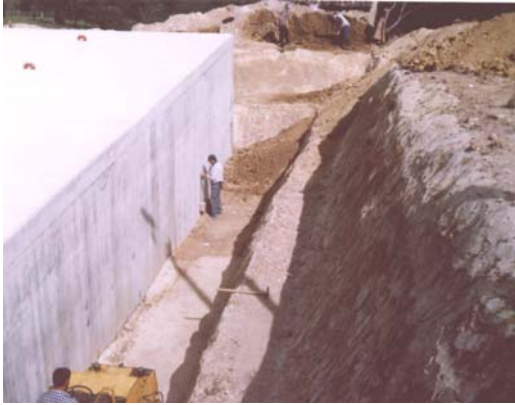
Figura 36. Estado Inicial Tanque Boyacogua
