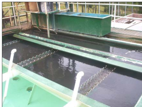
Figura 14. Dosificación y Filtros
