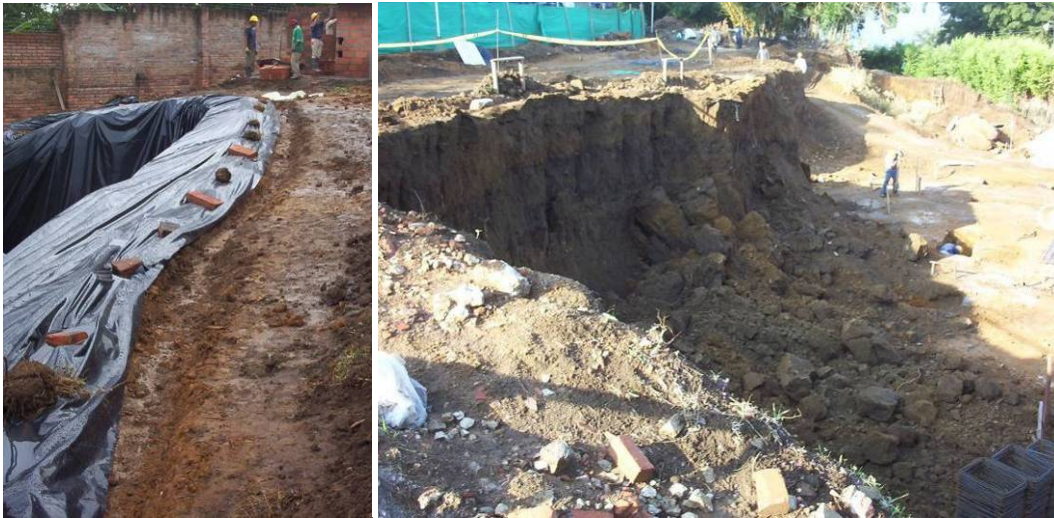
Figura 23. (izq) Geomembranas y zanja, (der) talud desestabilizado.
