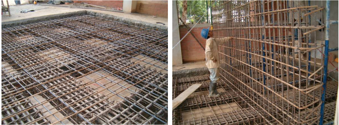
Figura 46. Instalación de malla para fibra superior de la losa y armado del muro.
