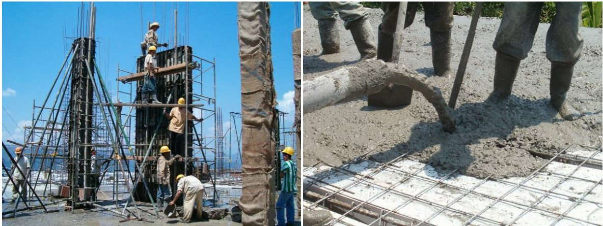
Figura 9. Fundida de columnas del nivel +0.00m y de placa de nivel +4.90m.
