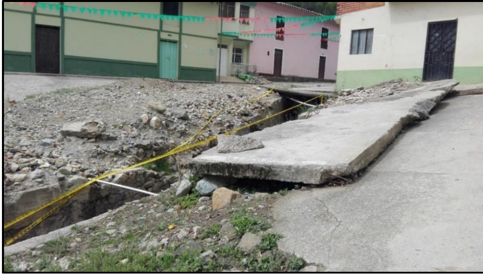
Figura 3. Levantamiento de las tapas o lozas ocurrido durante la inundación del año 2015.
