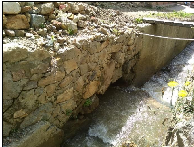
Figura 26. Daños laterales causados a estructuras dentro del corregimiento.
