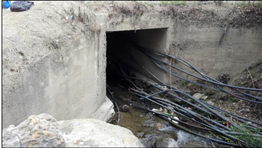
Figura 27. Acumulación de manegueras utilizadas para la captación de agua.
