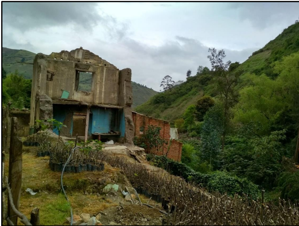
Figura 1. Antiguo molino destruido por la inundación presentada en el año 2011.
