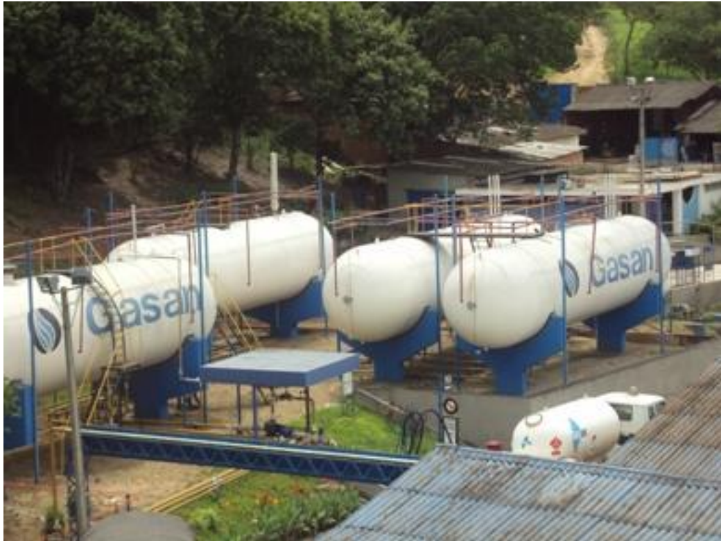
Figura 10. Transferencia interna entre tanques.
