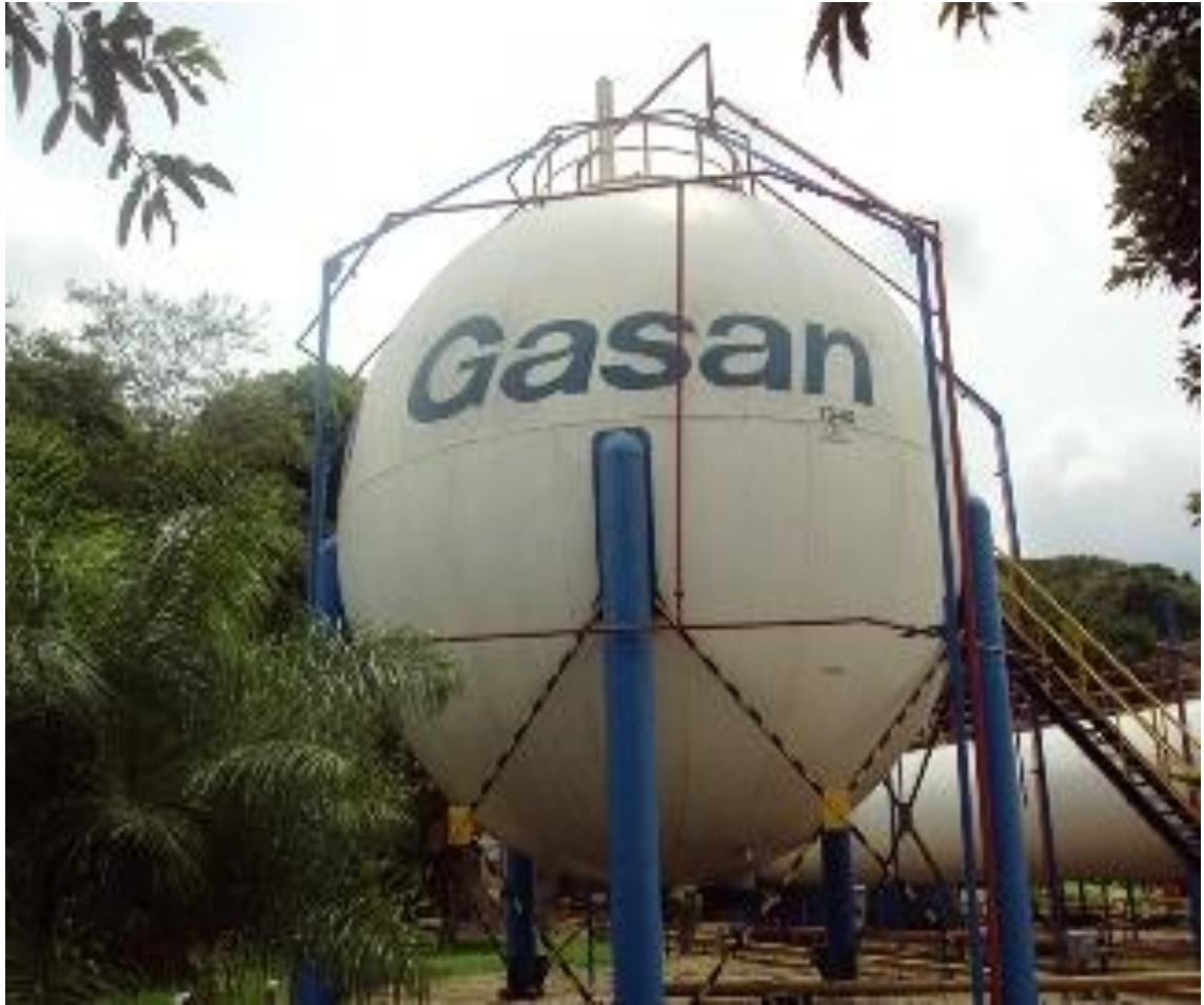
Figura 8. Planta principal de envasado de GLP.
