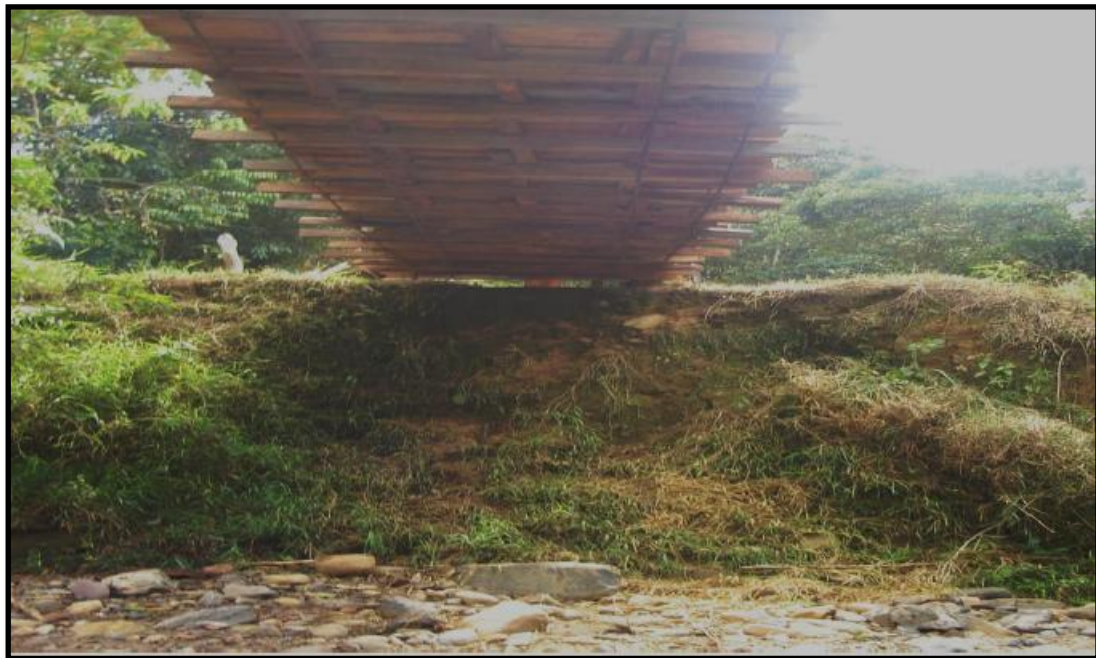
Fotografía 3. Estribo izquierdo completamente destruido.
