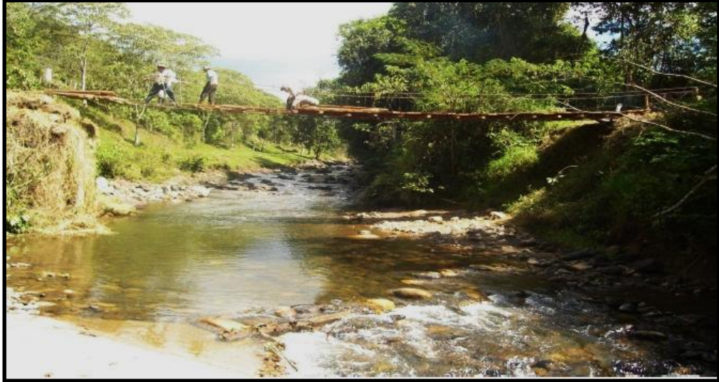
Fotografía 2. Puente colgante existente, se observa el deterioro de los estribos.
