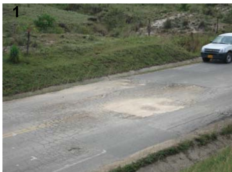
FOT. 1- ESTADO GENERAL DE LA CARPETA ASFALTICA-
