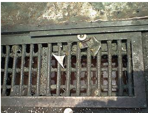
Foto 45. Rejilla de aguas lluvias planta I
