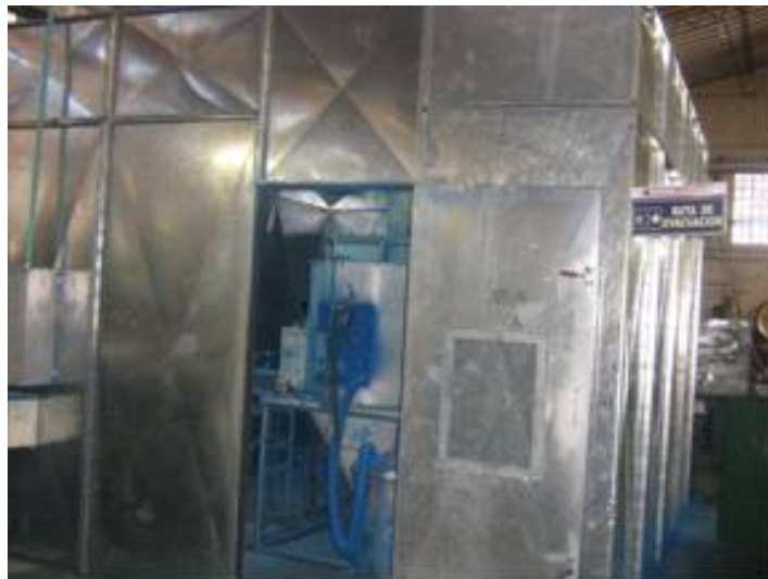
Foto 24. Cabina de pintura
