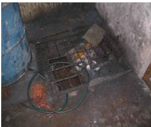
Foto 47. Rejilla aguas domésticas planta II
