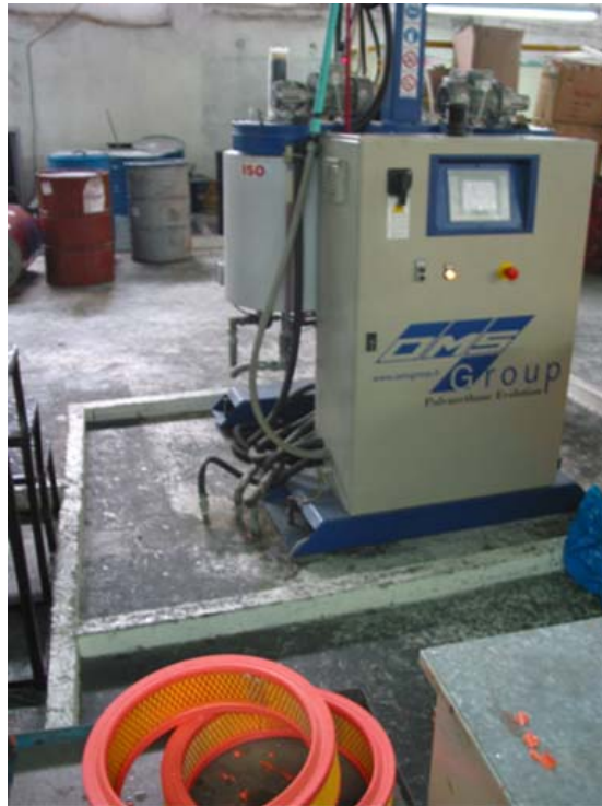
Foto 65. Dique de contención máquina de poliuretano planta II
