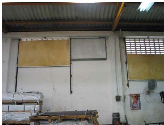
Foto 76. Paneles de insonorización planta I
