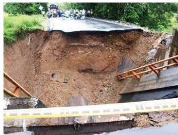
Figura 2. Colapso puente Quebradaseca. [2]
