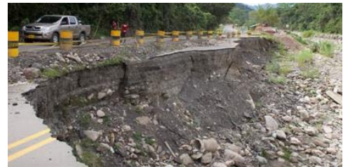
Figura 4. Colapso vía Bucaramanga-Cúcuta. [4]
