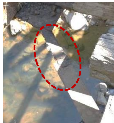
Figura 36. Corrosión presentada en el arriostramiento inferior.
