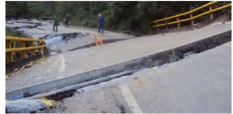
Figura 3. Colapso vía Bucaramanga - Barrancabermeja. [3]
