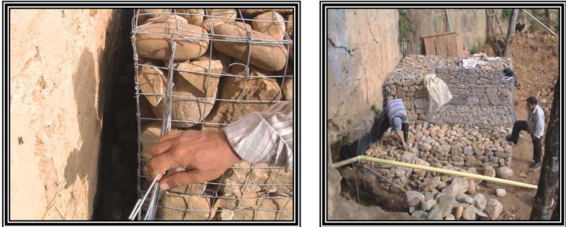
Fuente: Obras de Estabilización de taludes Construcción muro en gaviones Barrio Colombia (Registro Fotográfico). CDMB
