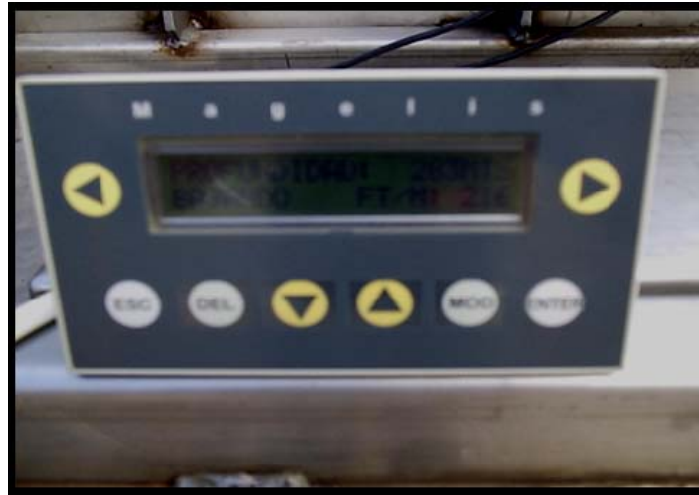
Figura 30. Pantalla Panel de Control.
