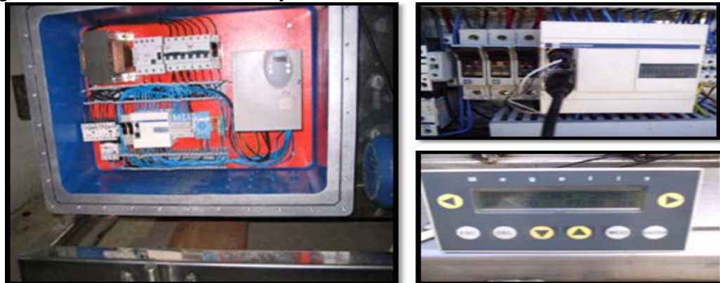
Figura 60. Sistema de control y Alimentación Eléctrica
