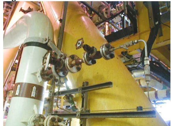
Figura 36 Tubería en Cantiléver
