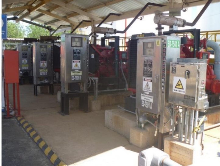
Figura 12 Sistema Contra incendio
