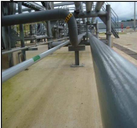
Figura 39 Corrección Tuberías sin soporte 2
