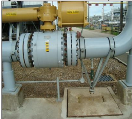
Figura 38 Tuberías sin soporte 1
