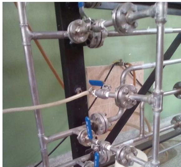
Figura 3. Valvula de vaciado de sistema.
