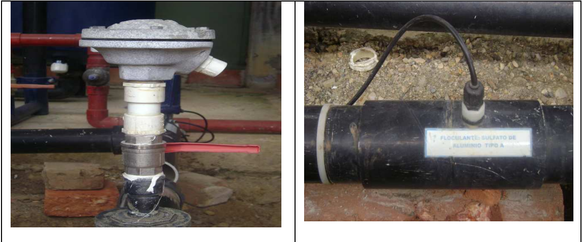
Fotos PTAP compacta
