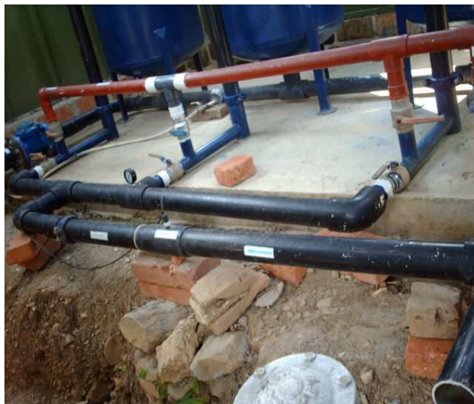
Figura 7. Sistema de floculación
