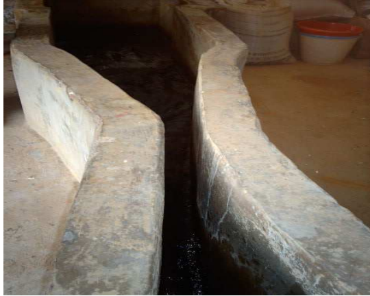
Figura 5. Canaleta Parshall acueducto
