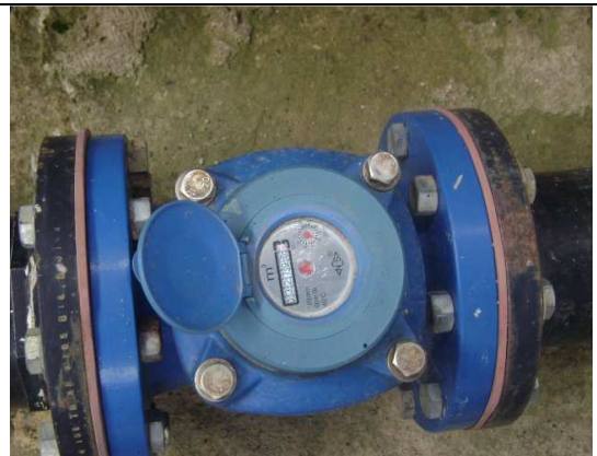
Medidor de caudal
