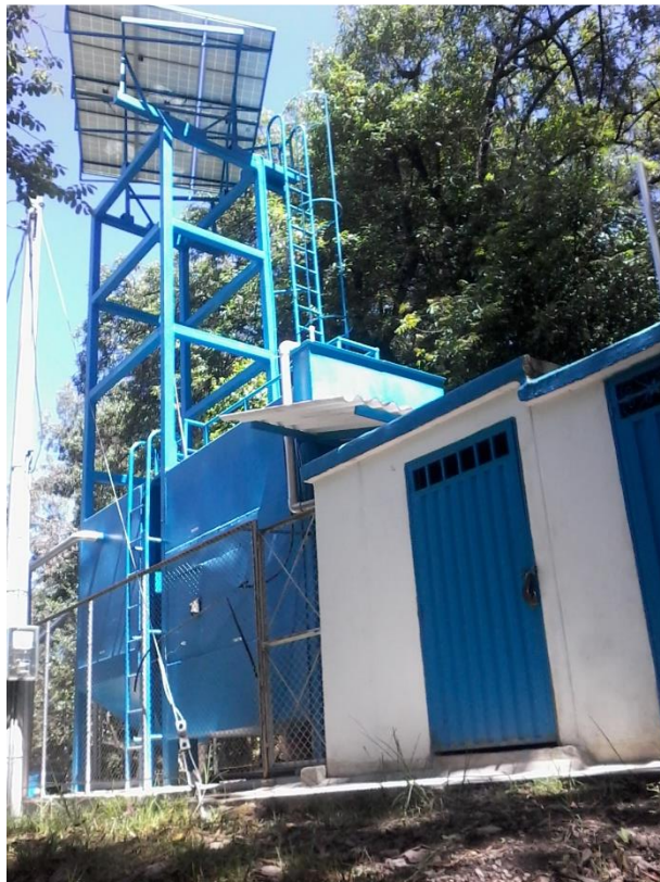
Apéndice 27. Tanque de almacenamiento y tratamiento de agua, Quebrada el Tejar.
