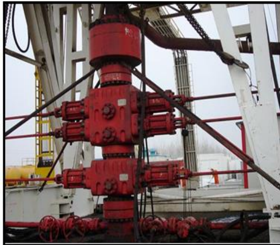
Figura 8. Sistema de prevención de reventones
