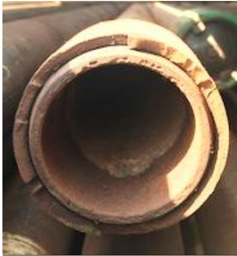
(1) Corrosión severa en el extremo del tubular
