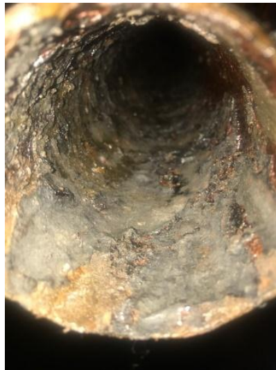
(3) Corrosión severa al interior del tubular
