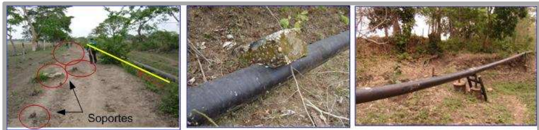
Figura 32. Ejemplo de tubería por fuera de los soporte. .
