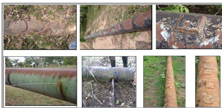
Figura 29. Evidencia de instalación de válvulas y perforaciones Ilícitas.
