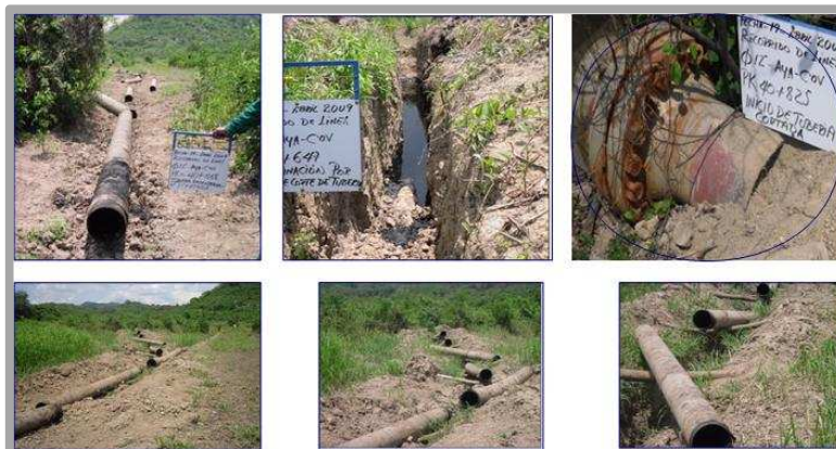
Figura 31. Hurto de Tubería.
