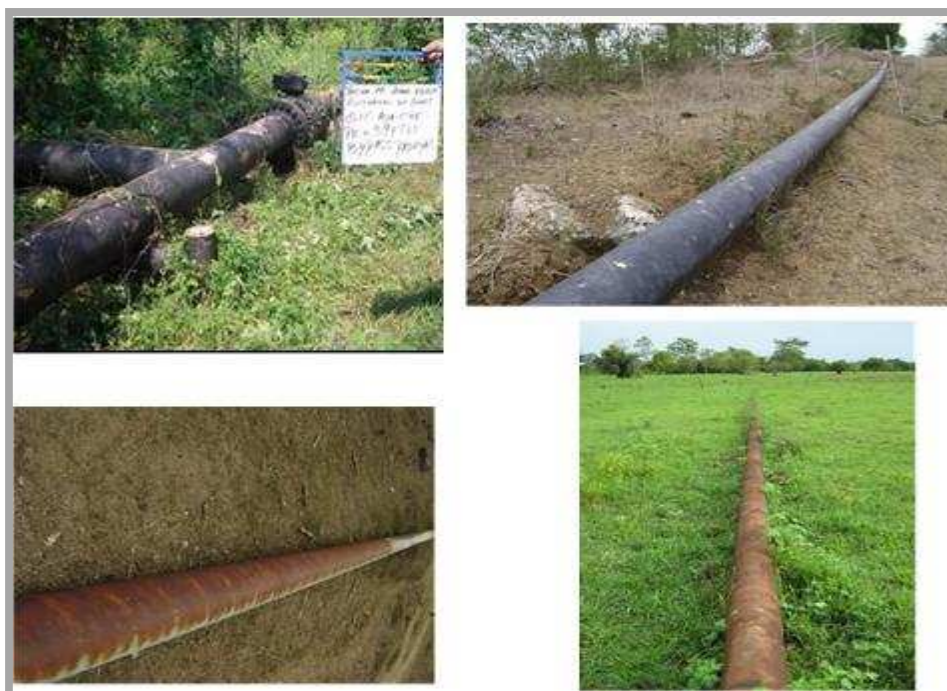
Figura 27. Estado del recubrimiento. .
