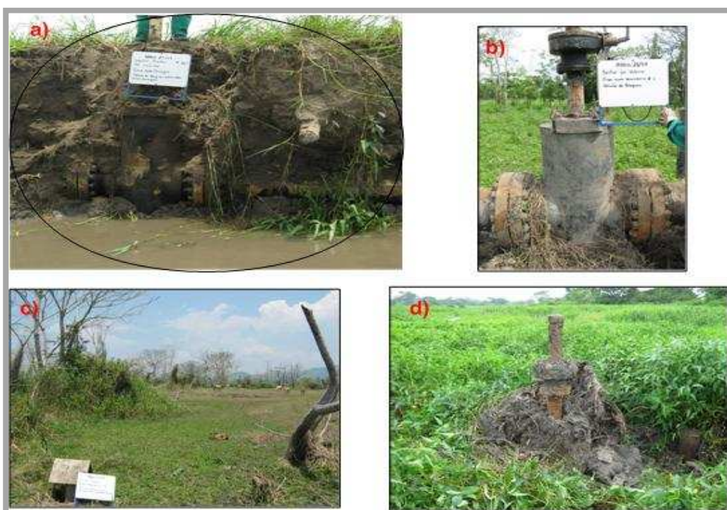
Figura 22. Válvula de bloqueo y tubería tapada por depósitos aluviales a) Km 113+318 Caño Chicagüa, b) V. Victoria Km 107+743 c) Tubería tapada Km 74 al Km 75 d) V. Caño Tapoa Km 72+909. .
