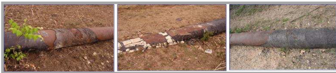
Figura 28. Ejemplos de interfaces en mal estado. .
