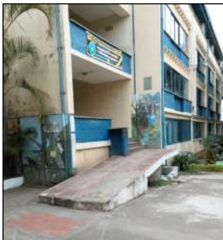
Figura 7. Adecuaciones para discapacitados
