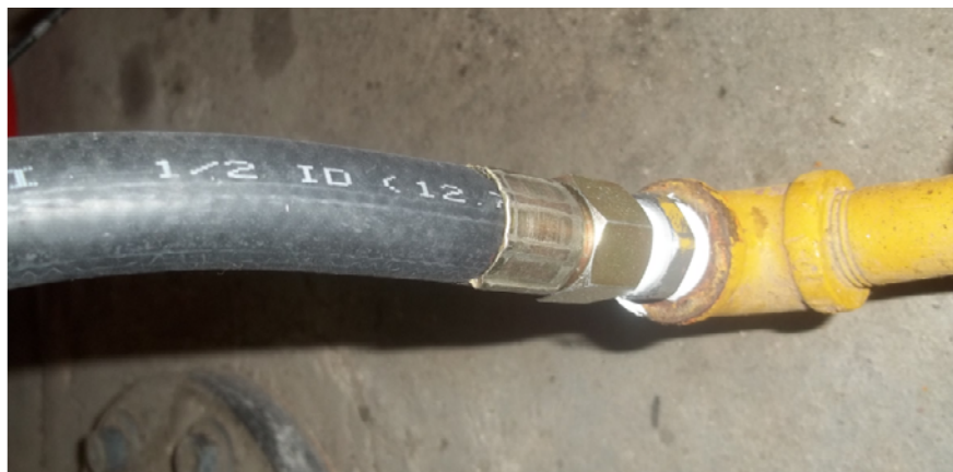
Figura 20. Manguera de alimentación de gas
