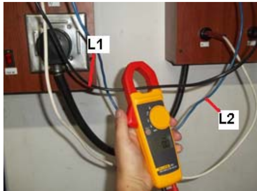
Figura 9. Medir voltaje entre líneas.
