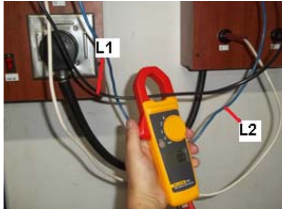
Figura 68. Medir corriente de las líneas L1 (cable negro) y L2 (cable azul).
