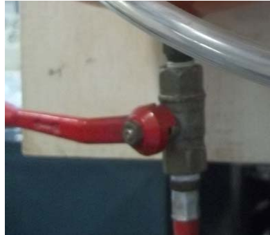
Figura 5. Llave de paso de combustible.
