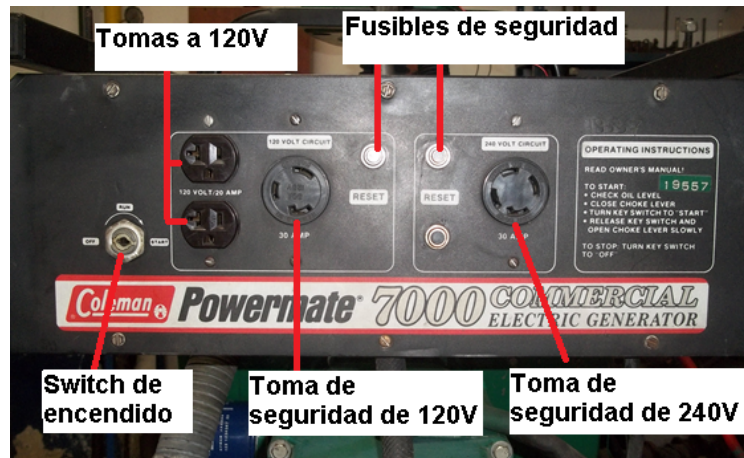
Figura 56. Tablero del generador.
