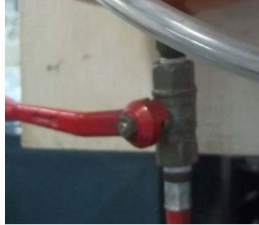
Figura 10. Llave de paso de combustible.
