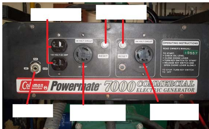
Figura 2. Tablero del generador.
