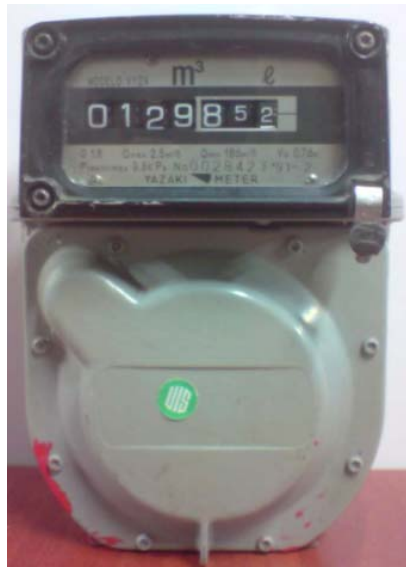
Figura 50. Medidor de gas del grupo electrógeno.
