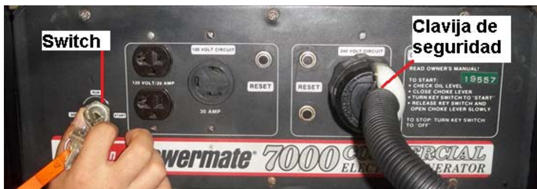
Figura 66. Switch del encendido del motor.
