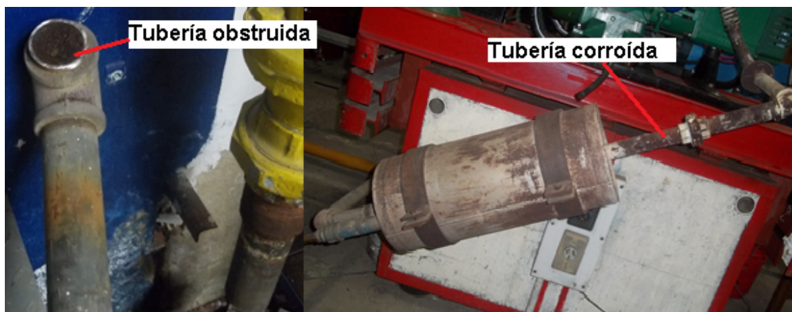
Figura 39. Tubería inicial de escape.
