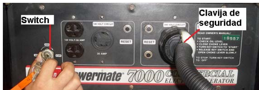
Figura 8. Switch del encendido del motor.
