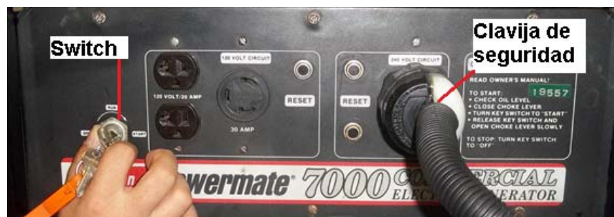
Figura 13. Switch del encendido del motor.
