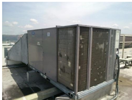
Figura 46. Incidencia solar en la Unidad Condensadora del Auditorio.
