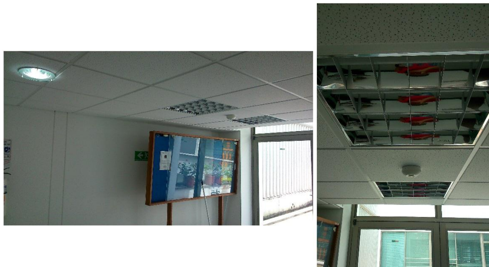
Figura 28. Exceso de Luminarias.
