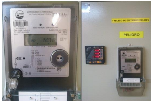
Figura 8. Medidor de Electricidad de Tarifas Múltiples.
