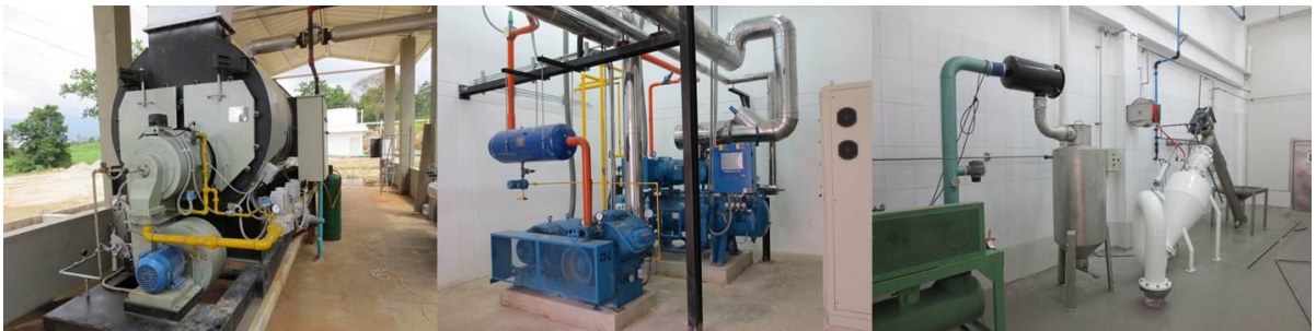
Figura 10. Sistemas de refrigeración, vapor y bombeo de grasa y pieles
