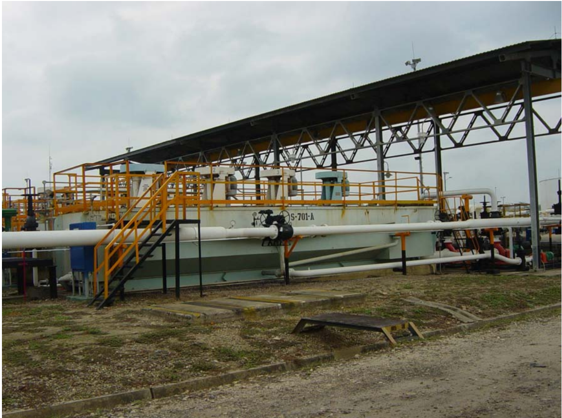
Figura 9. Celda de Flotación. Unidad Wemco S-701-A.
