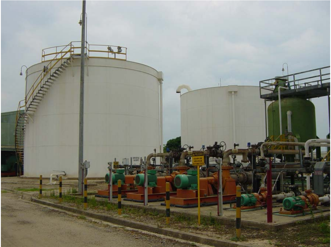
Figura 16. Tanques de Cabeza T-790 A/B
