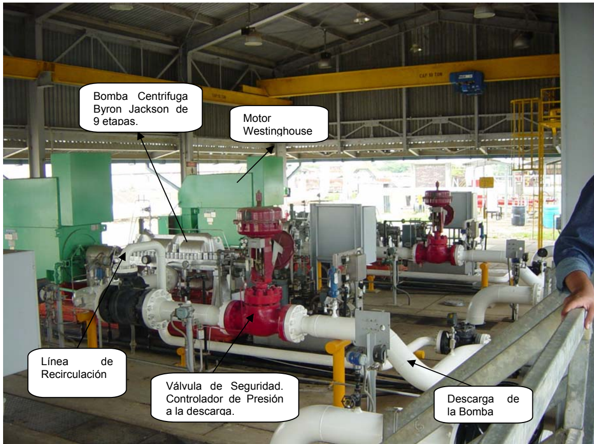
Figura 18. Estación Bombas de Inyección de Agua.
