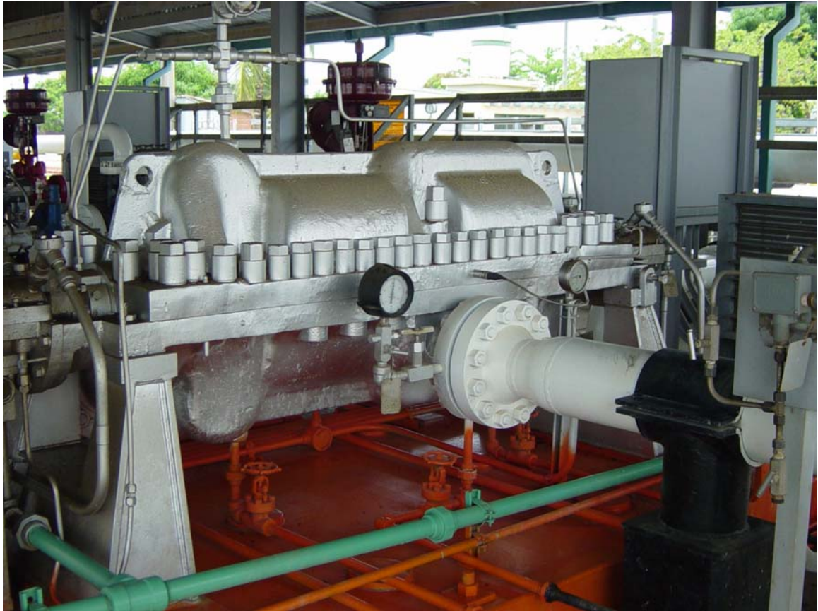
Figura 17. Bomba de Inyección de Agua.
