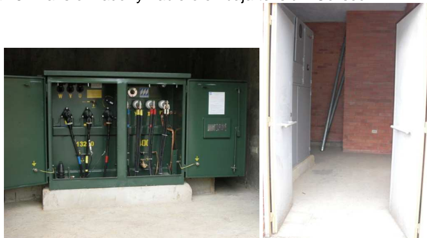
Figura 18. Transformador y Tablero en baja tensión. Coliseo.
