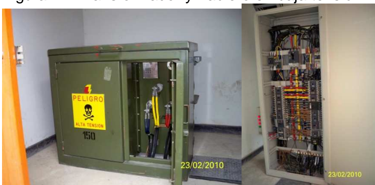
Figura 22. Transformador y Tablero en baja tensión Edificio Jorge Bautista Vesga.
