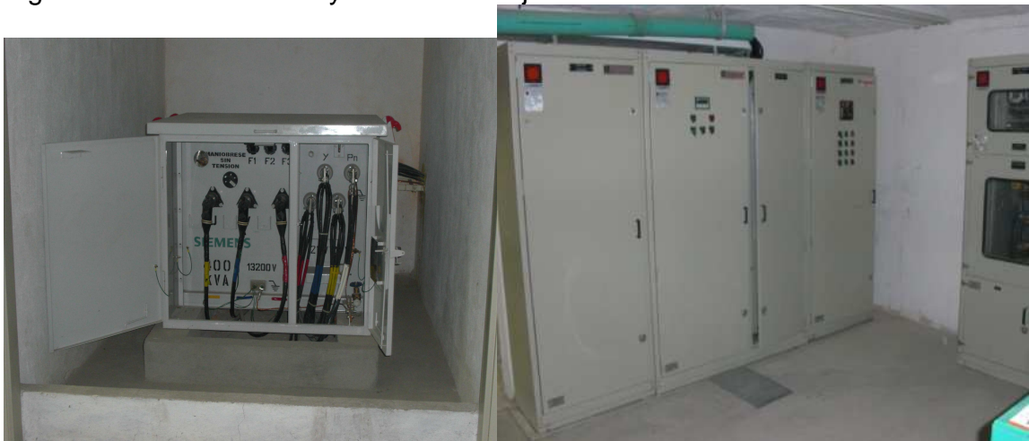
Figura 20. Transformador y Tablero en baja tensión Edificio Ciencias Humanas.
