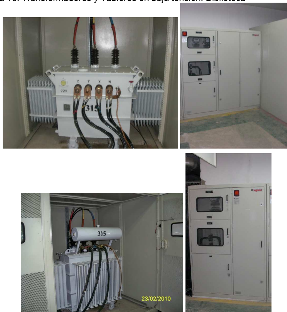
Figura 16. Transformadores y Tableros en baja tensión. Biblioteca
