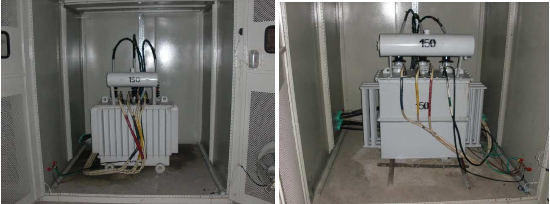
Figura 26. Transformador y Tablero en baja tensión Edificio Jorge Bautista Vesga.
