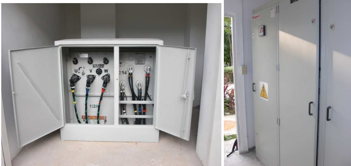
Figura 12. Edificio de Administración II. Transformador y Tablero en baja tensión.
