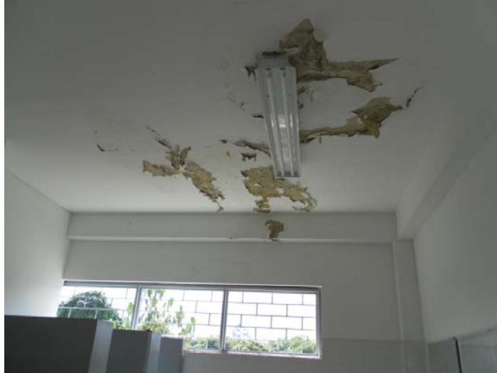
Humedad Baño de Hombres cuarto piso (Edificio LL) – Laboratorios de Física (Construidos en 2006)
